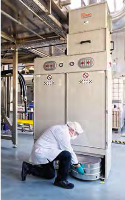
Bei diesem Einsatzfall eines DS6-Entstaubers als Tandemanlage in der Kosmetikproduktion wurde die Antriebseinheit im Freien aufgestellt
