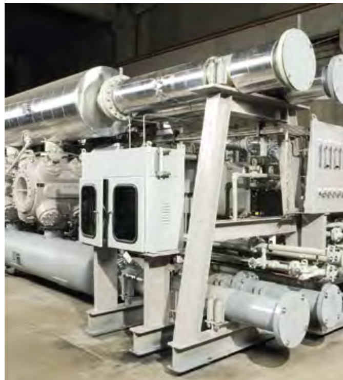
Der Einsatz von PFAS-Kunststoffen als Dichtungsmaterial in solchen Kompressorenanlagen ist derzeit alternativlos
