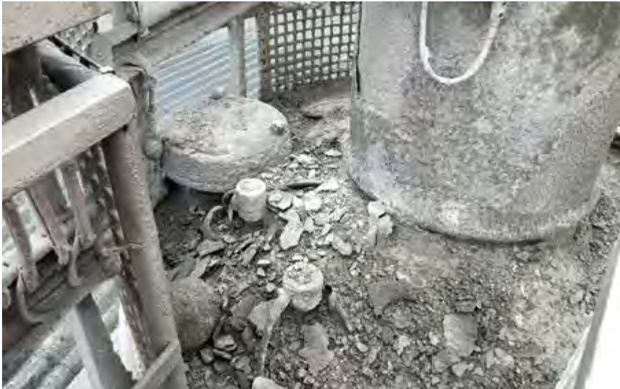
Sicherheitskomponenten auf dem Silo – begraben von Material
