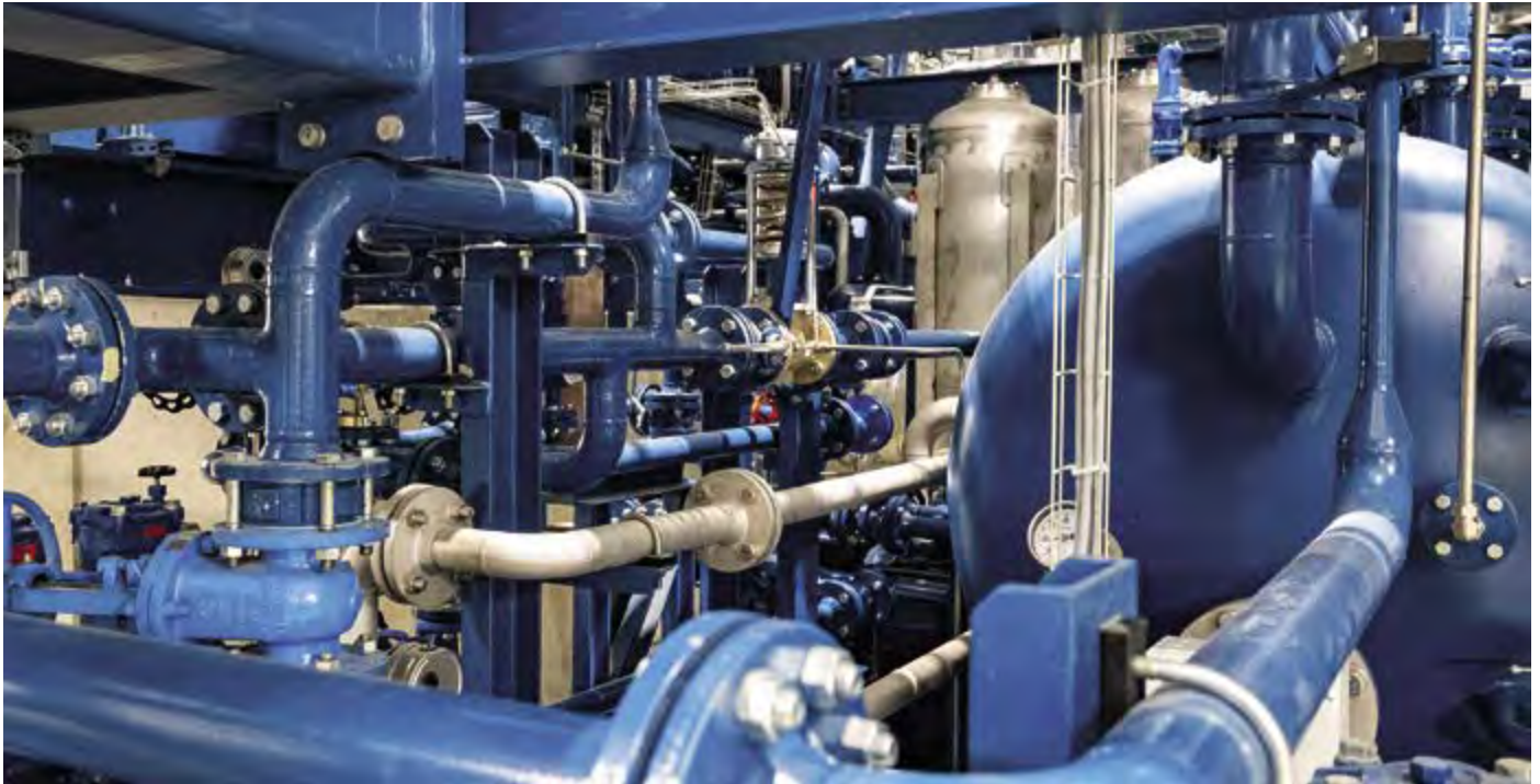
Insgesamt wurden gut 500 Meter Rohrleitungen verbaut, von DN 200 bis DN 1000, Bild: AERZEN
