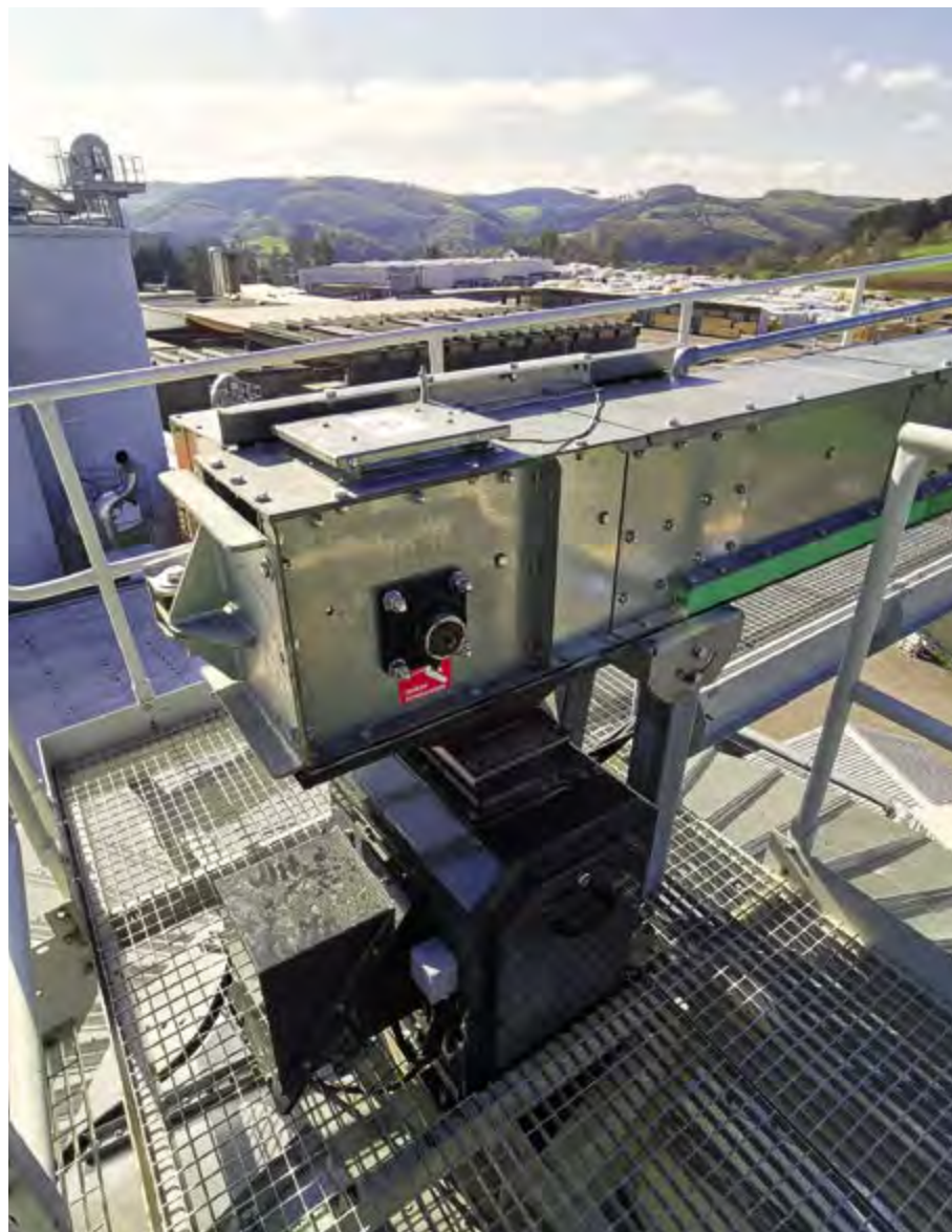
Auf dem Silodach verwiegt die Prallplattenwaage im vertikalen Durchlauf
