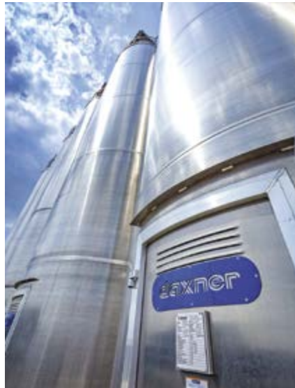
Lagerung der Großkomponenten in Außensilos
