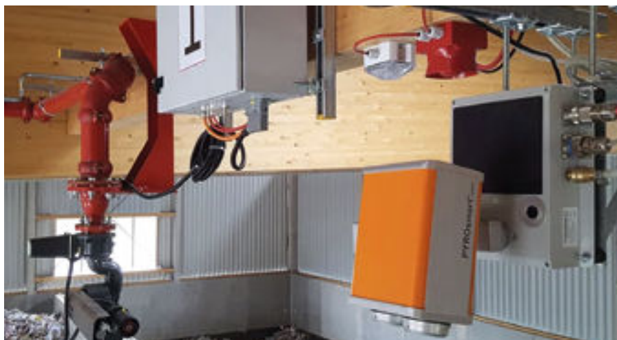
PYROsmart® mit angebundenem Löschwerfer in einer Recyclinghalle
