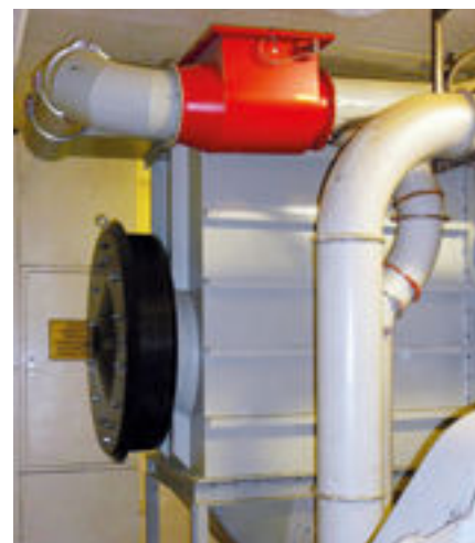
Flammlose Entlastungseinrichtung eines Infastaub-Aspirationsfilters
