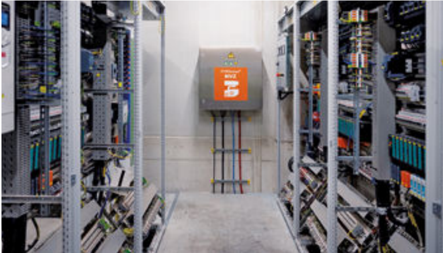
Orglmeister liefert die gesamte Systemtechnik zur sicheren Überwachung, die in einem kleinen Schaltschrank im elektrischen Betriebsraum der Halle untergebracht ist
