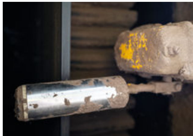
Die eingebauten Rollenhebel werden trotz regelmäßiger Druckluftbehandlung durch das Fördergut verunreinigt, der Lack über die vielen Jahre hinweg angegriffen. Die Funktionstüchtigkeit sämtlicher Schalter blieb davon jedoch völlig unbeeinträchtigt. (Detailansicht rechts)
