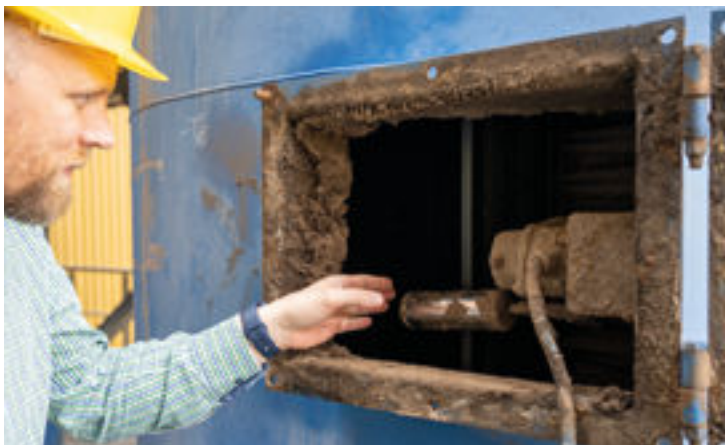
Inspektion eines Schaltergehäuses bei E.ON: Hinter einer Revisionsklappe befindet sich ein über 13 Jahre alter Schieflaufschalter von Kiepe Electric mit Edelstahlrolle unter einer Schicht von Holzstaub und Schmutz. Kurz nach dem Einbau kümmerte sich Kiepe 2010 darum, den Schalter umzumontieren und dadurch die Beweglichkeit des Rollenhebels zu verbessern. Dieser wurde in diesem Jahr zum ersten Mal ersetzt.
