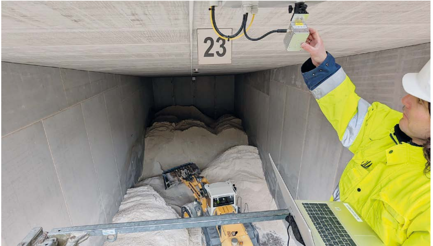
Inbetriebnahme einer Owl Eye-Anlage
