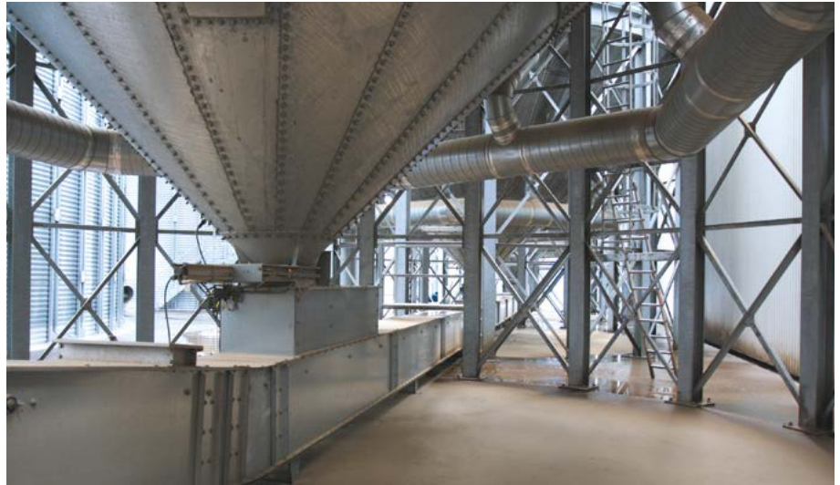
Der längste horizontale Förderer in der Anlage deckt eine Entfernung von 130 Metern ab
