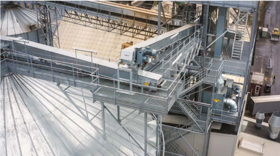
Die Anlage kann zehn Lkw pro Stunde annehmen. Das entspricht 300 Tonnen pro Stunde, die in die Silos gefördert werden müssen.
