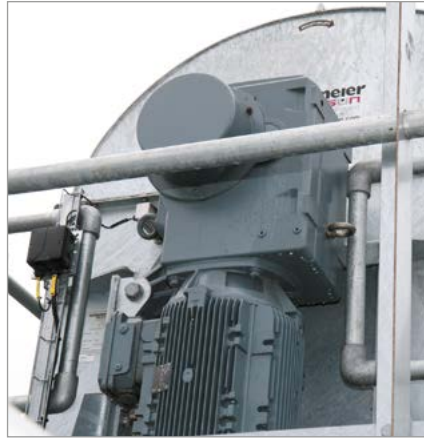
NORD-Getriebemotoren mit Rücklauf Sperre für die Becherwerke im Getreideterminale
