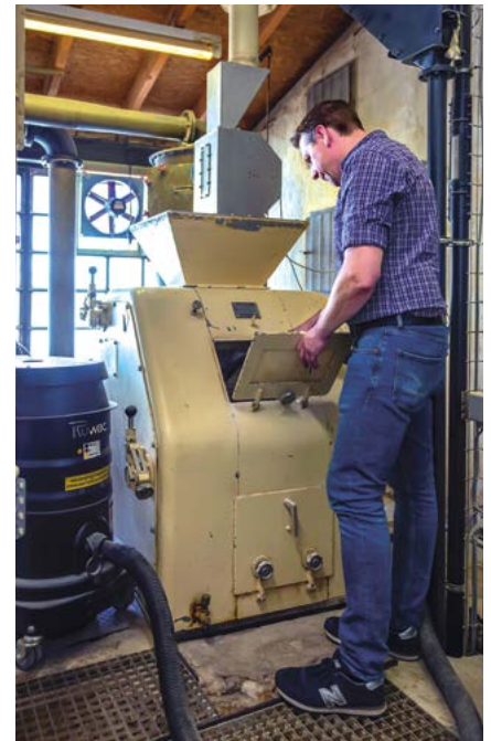
Nicht nur im Umfeld des Saugers kann gesaugt werden, sondern auch im Geschoss darunter, denn der Sauger ist über eine Rohrleitung mit einem Absaugarm am Schüttelsieb verbunden
