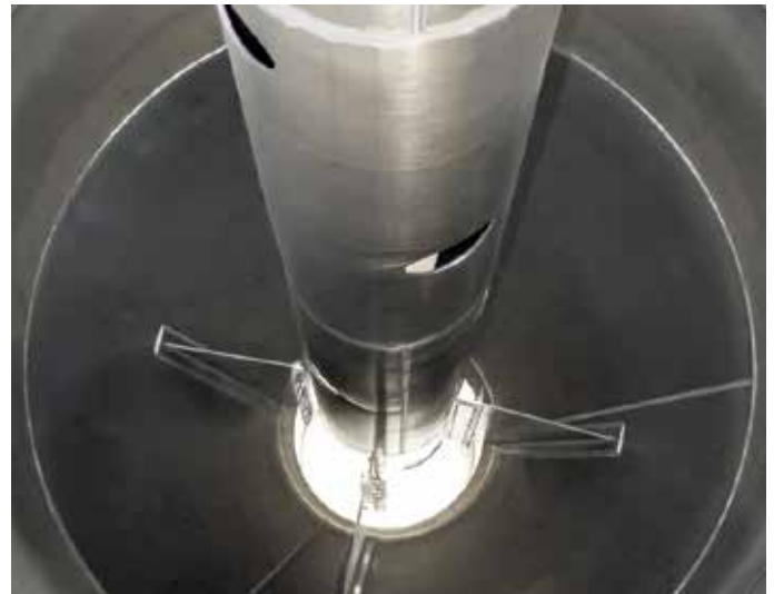
Blick in das Mischsilo Centro-Blend. Dieses ist wartungs- und verschleißarm und sorgt für ein optimales Mischergebnis
