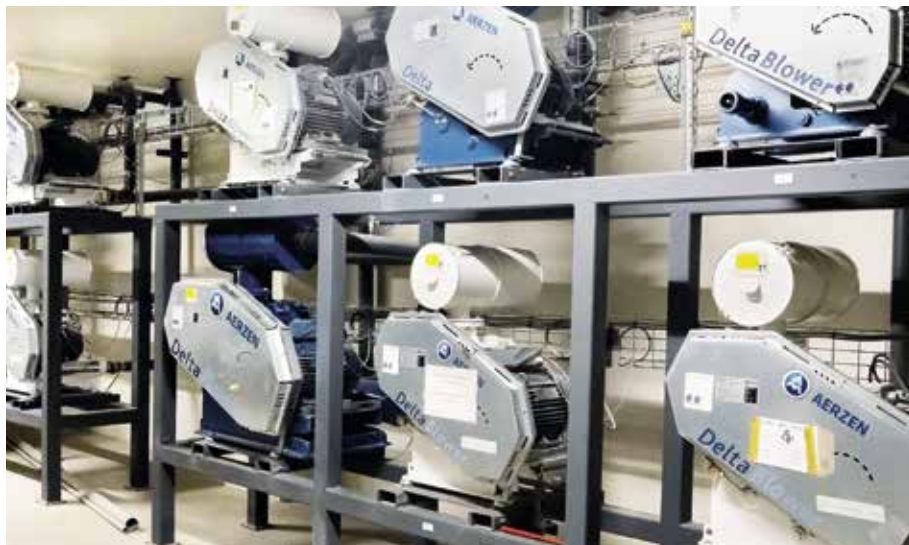
Insgesamt 21 AERZEN Drehkolbengebläse vom Typ Delta Blower halten die Flockenproduktion am Laufen (Bild: AERZEN)
