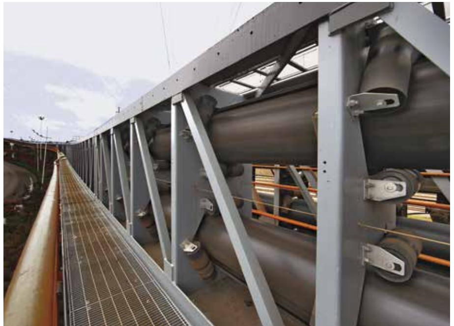
Das System wird innerhalb einer geschlossenen Galeriestruktur installiert, um die Wartung während der Wintermonate zu erleichtern
