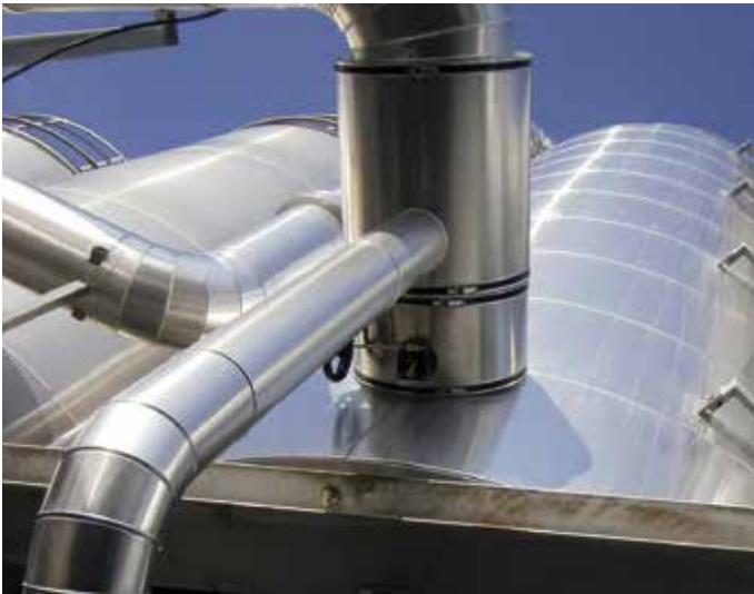
Das Kunststoffgranulat wird auf die benötigte Prozess-temperatur erhitzt und dann in einem Silo mit Luft durchspült
