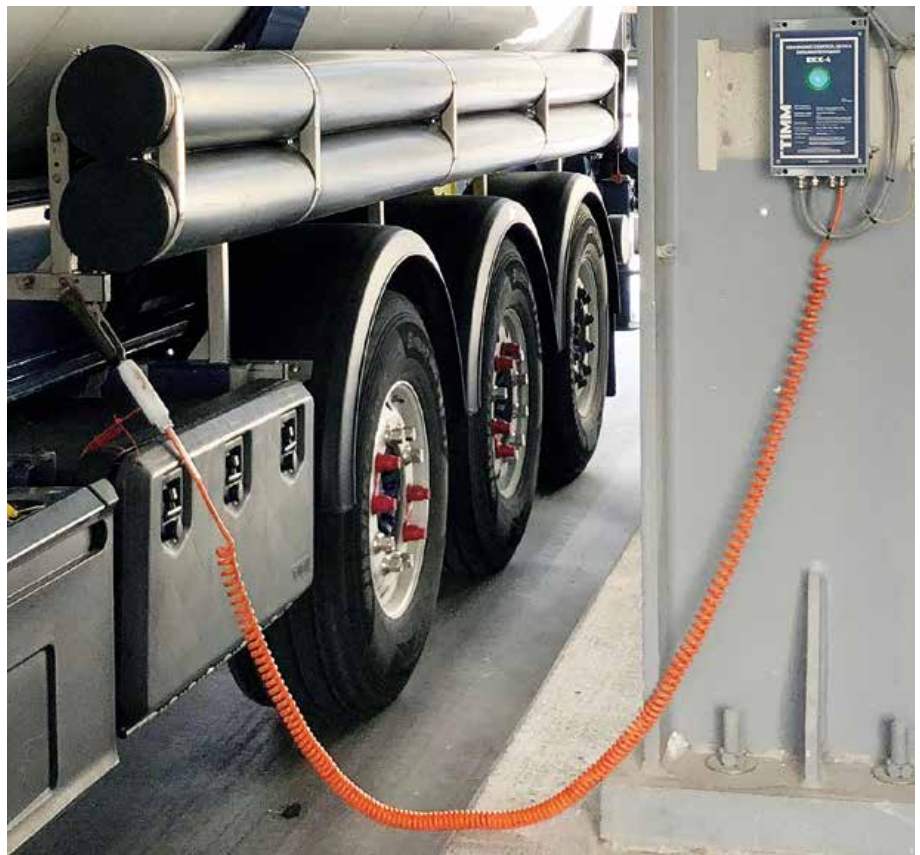
Überwachte Erdung eines Silo-LKW mit dem TIMM EKK-4
