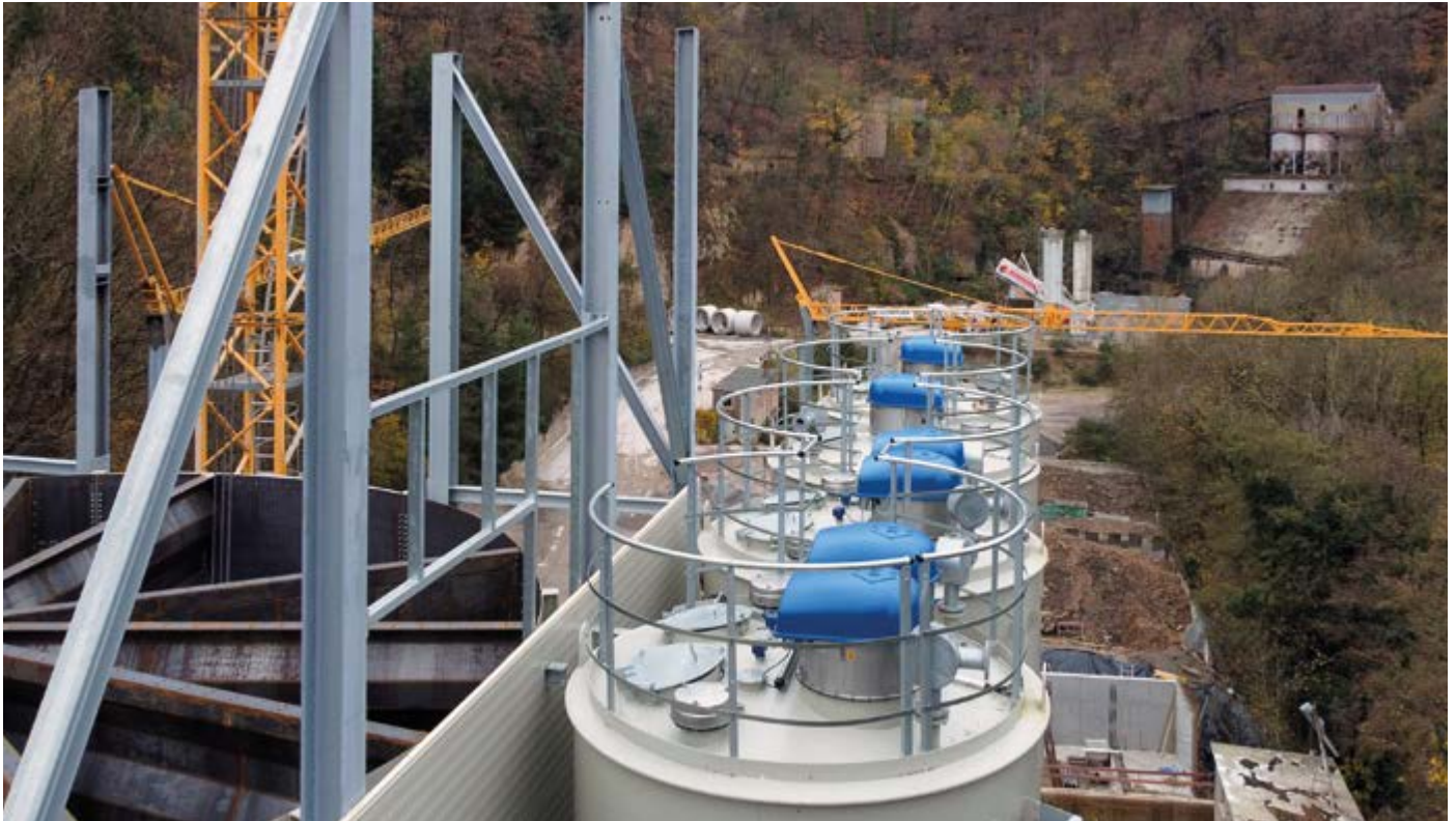
SILOTOP® polyTUBE TM Filtersystem im Einsatz bei Transportbeton Weinheim
