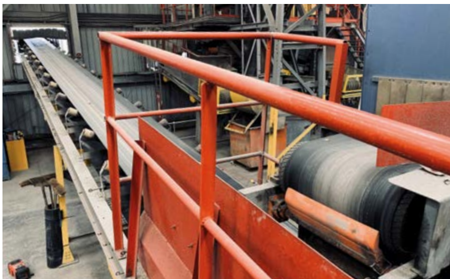
Eine Installation von Martins primären Förderbandreinigern reduziert das Verschütten
