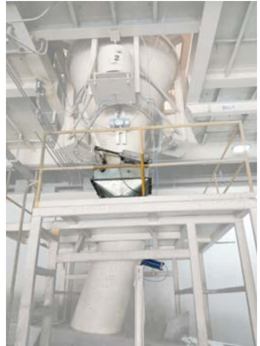
Klappenverschluss mit DN 400 (KV400E) an Behälterwaage und singold Klopfer K 80
