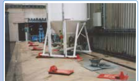
• Silos auf Rohrkettenförder
