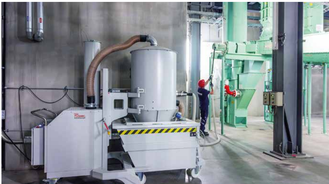
Als Saugaggregat wird ein Standard-Industriesauger mit 15 kW-Direktantrieb und rollbarem 500-Liter-Wechselcontainer unter dem höhenverstellbaren Filteraggregat verwendet (Bild: Ruwac)
