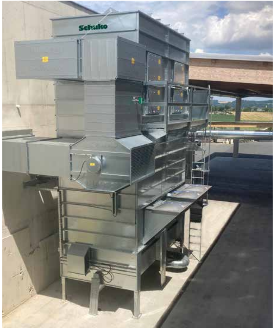
Eine Validus-Filteranlage bei der Gleichweit Objektischlerei GmbH
