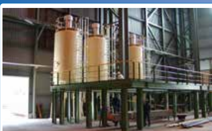
• Silos in Produktionsanlagen integriert
