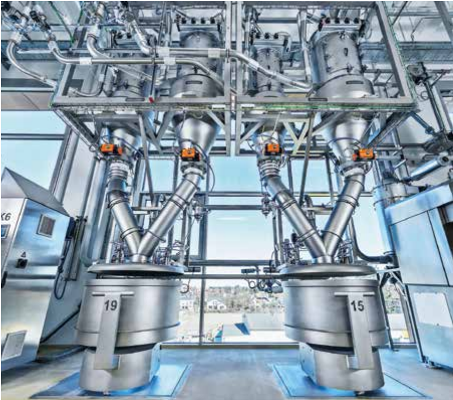
Zentrale Mehl- und Komponentenverwiegestation
