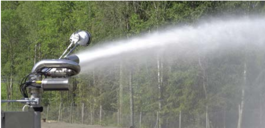
Löschmonitor Unifire Force 50 im Betrieb
