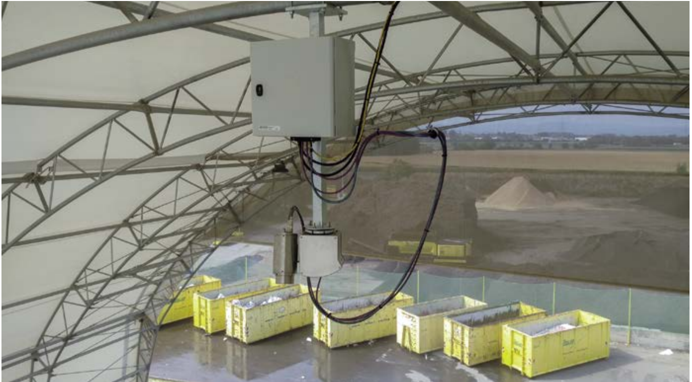
Containerüberwachung in der Freifläche
