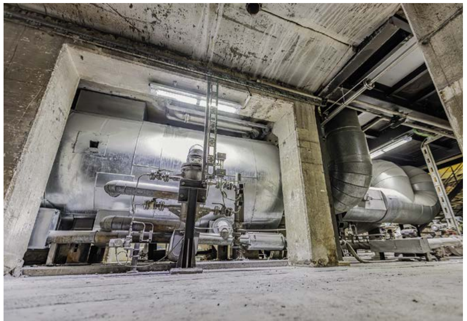
Der Schalldämpfer des VRO836 befindet sich eine Etage tiefer im Kellergeschoss
