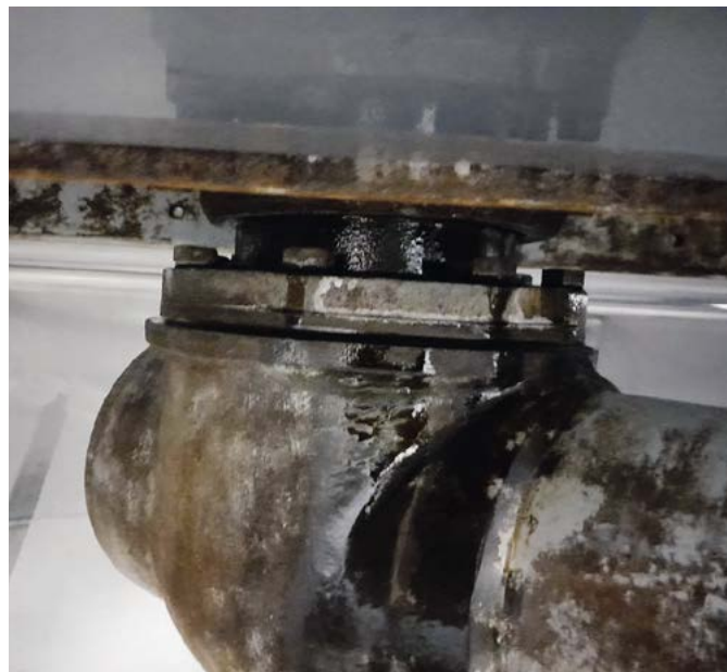
Die Leckage am Mischer
