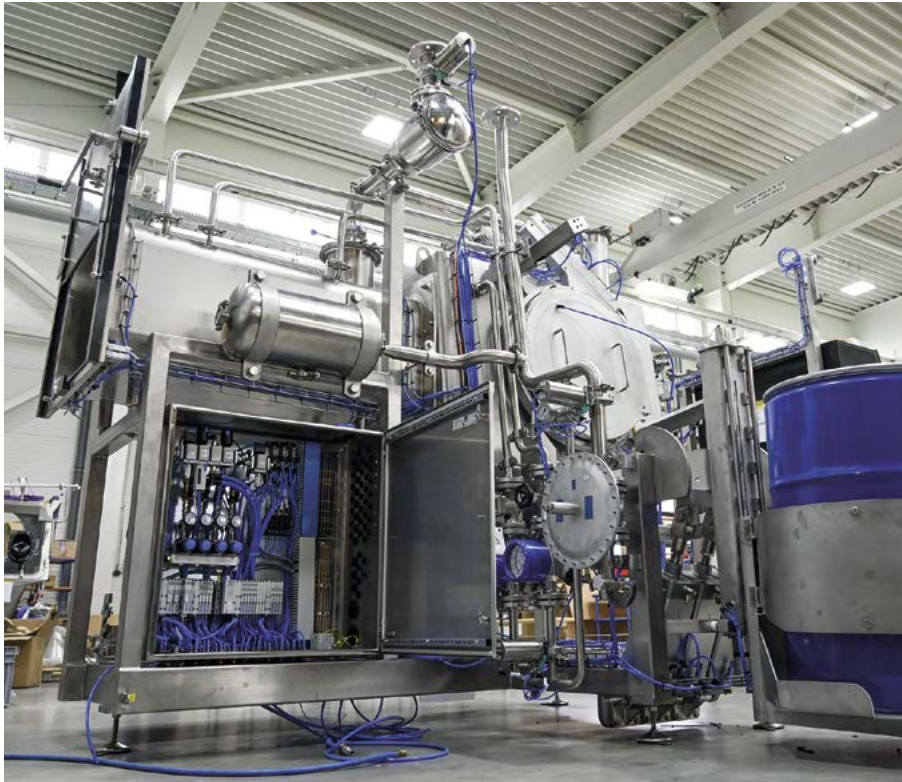
Eine gesicherte Fassentleerung
