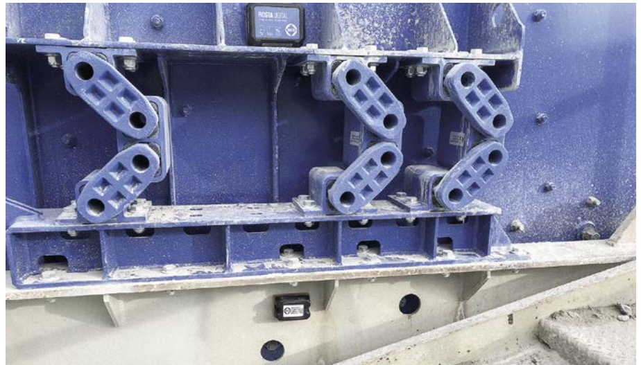
ROSTA-Elemente an der Siebanlage
