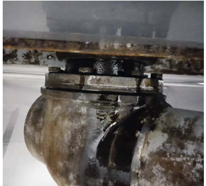
Die Leckage am Mischer
