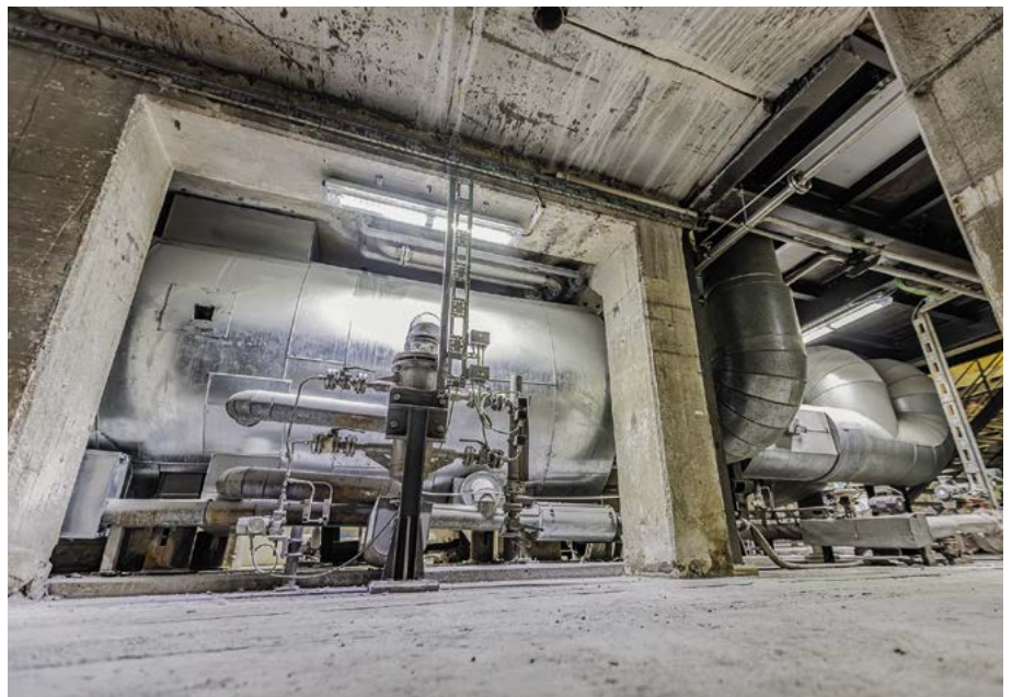
Der Schalldämpfer des VRO836 befindet sich eine Etage tiefer im Kellergeschoss
