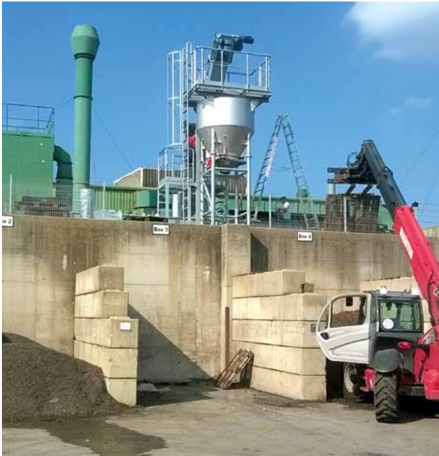
Die befeuchteten Stäube können anschließend problemlos auf einem Freilager gesammelt werden
