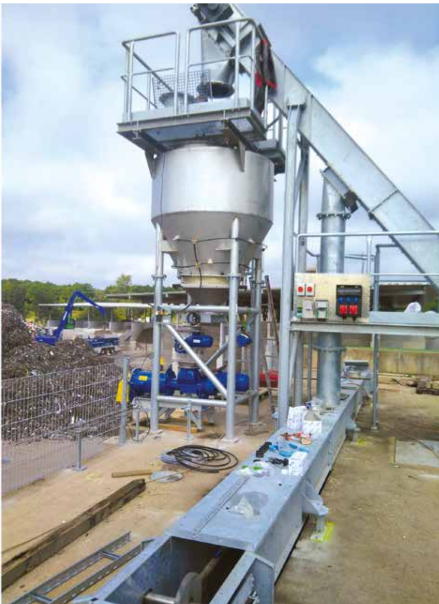
Die versandeten mineralischen und sonstigen Reste lagern im Silo, bevor sie mittels DUSTFIX befeuchtet werden
