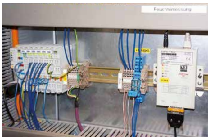
Elektronik im Schaltschrank
