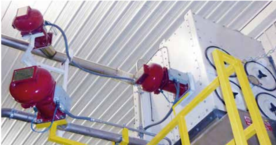
Die beiden Entkopplungssysteme links im Bild verhindern, dass eine Flammenfront sich im Rohrsystem ausbreitet. Das dritte, baugleiche Teil rechts erstickt – als Unterdrückungssystem verbaut – eine mögliche Explosion im Prozessbehälter bereits in der Entstehung (rechts).
