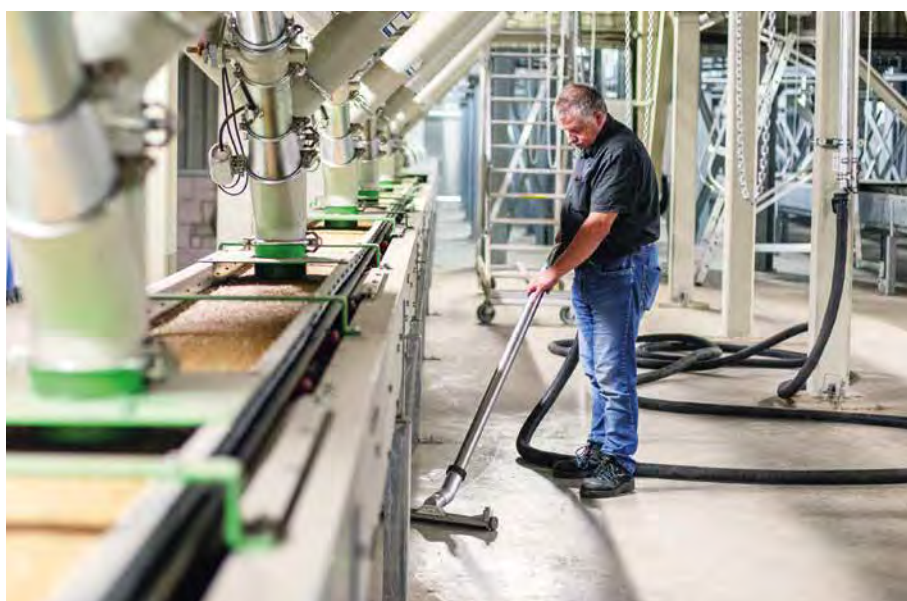
In der weitläufigen Aufbereitungsanlage sind überall Saugstutzen installiert. Wird dort ein Saugrohr angeschlossen, startet die zentrale Absaugung.
