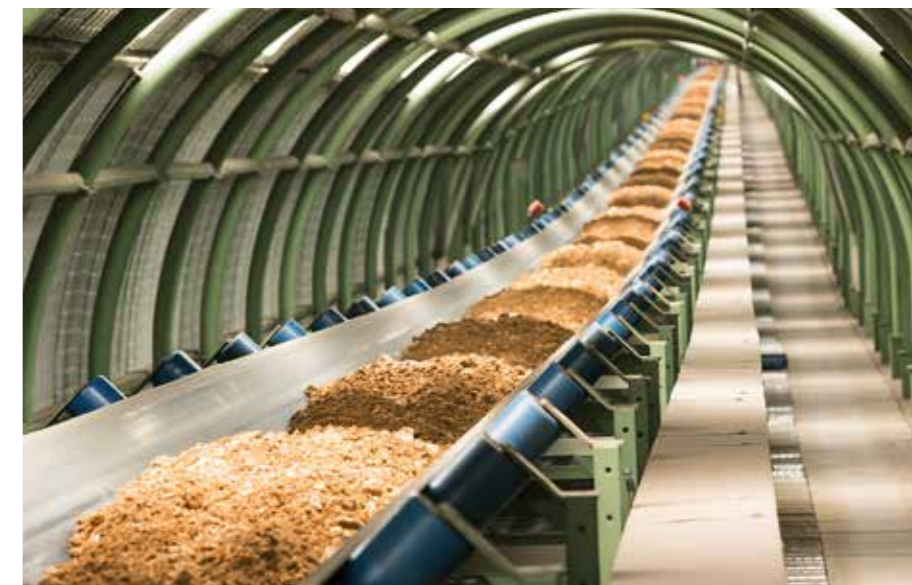
Blick in den Überlandförderer
