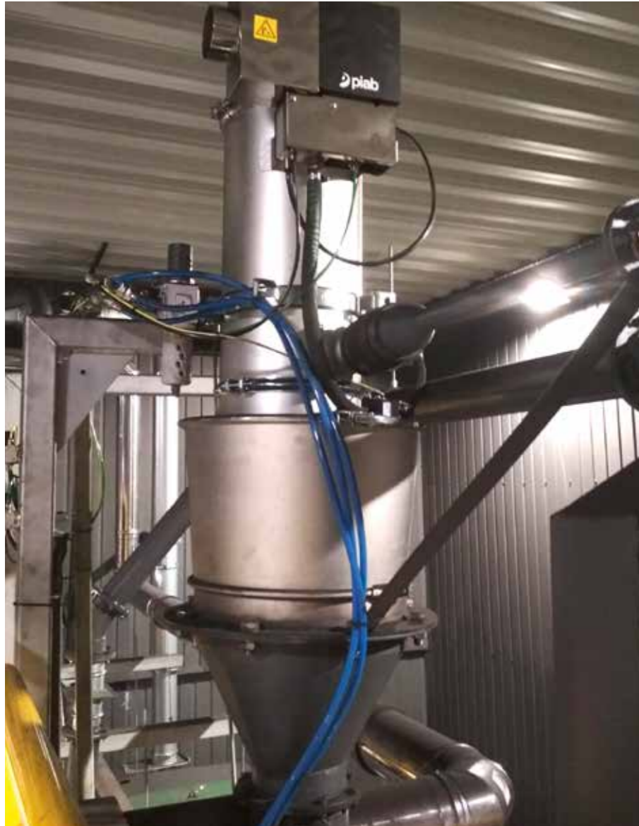
Bei einem Tierfutterhersteller: Piabs piFLOW®F-Vakuumförderer, auf dem Mischer des Conberg-Systems installiert
