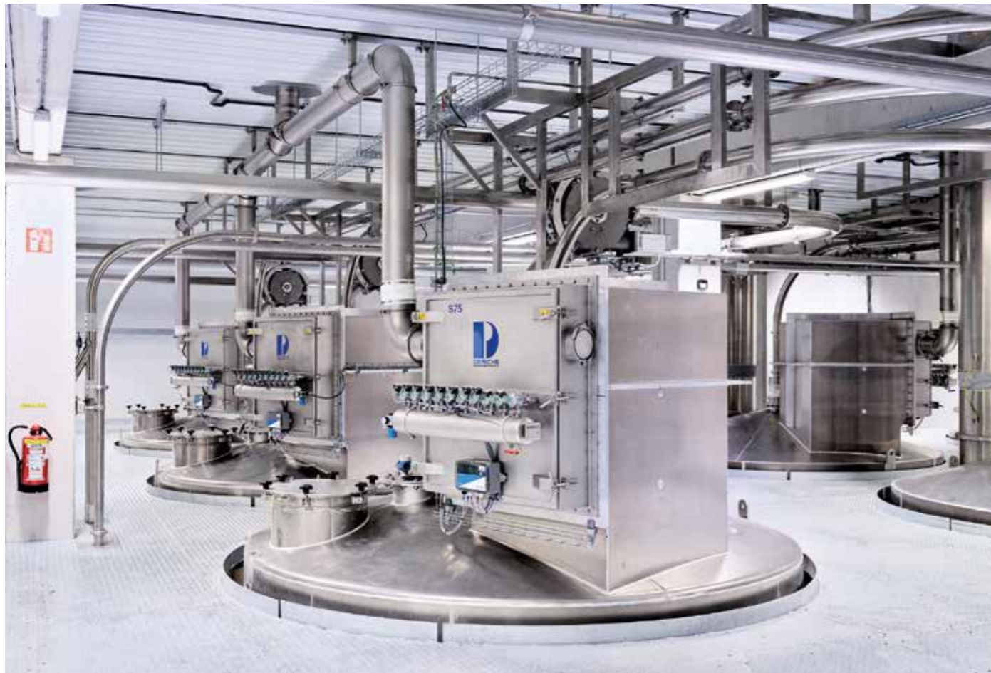
Verladesilos mit pneumatisch abreinigbaren Filtern
