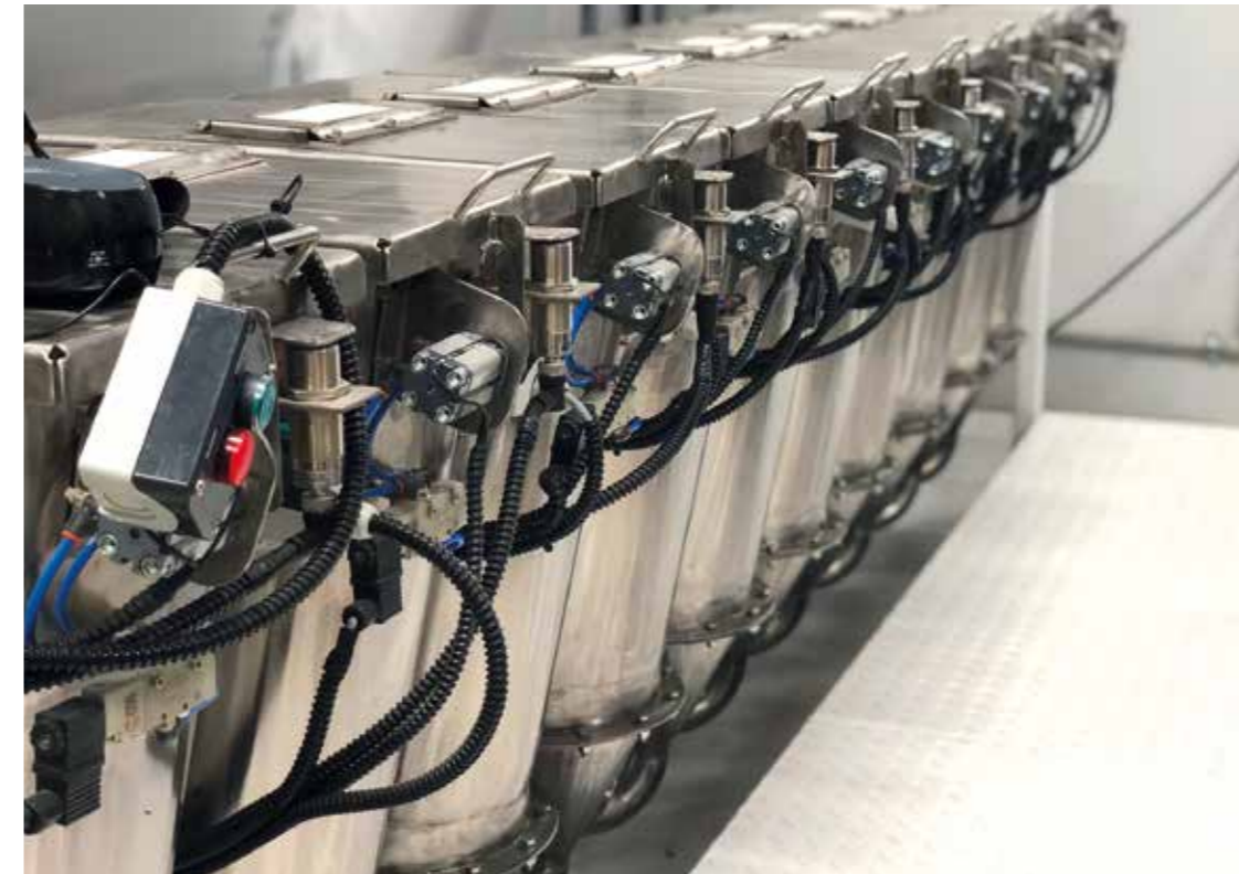
Bei einem Tierfutterhersteller: Piabs piFLOW®F-Vakuumförderer, auf dem Mischer des Conberg-Systems installiert
