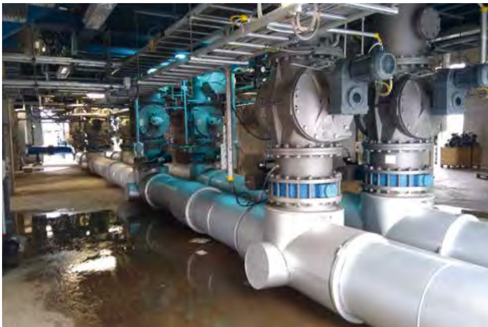
Untere Zellenradschleusen und Förderleitung (© RWE Niederlande/FLSmidth Hamburg GmbH)
