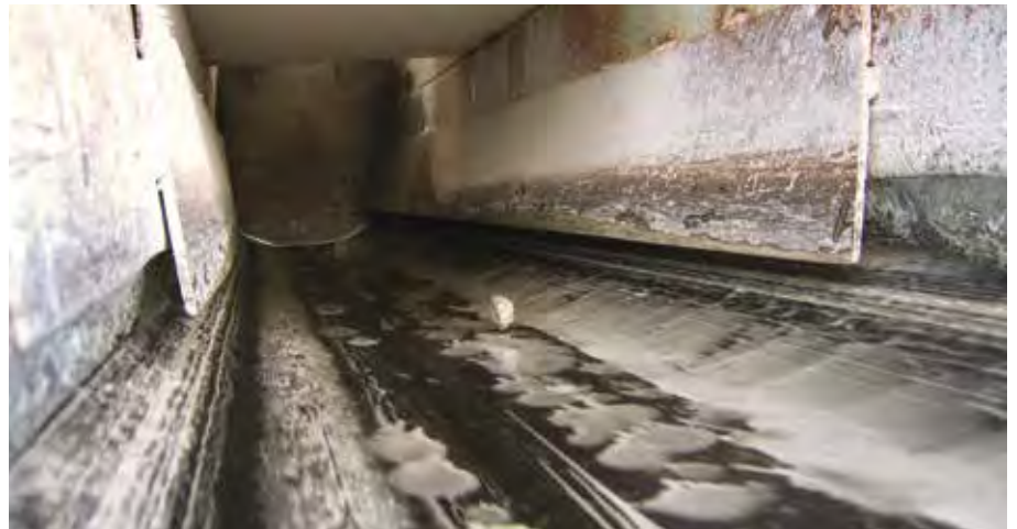
Bild 6: Die Lenkblechverschleißauskleidung sorgt für einen freien Bereich zwischen der Auskleidung und dem Abdichtsystem
