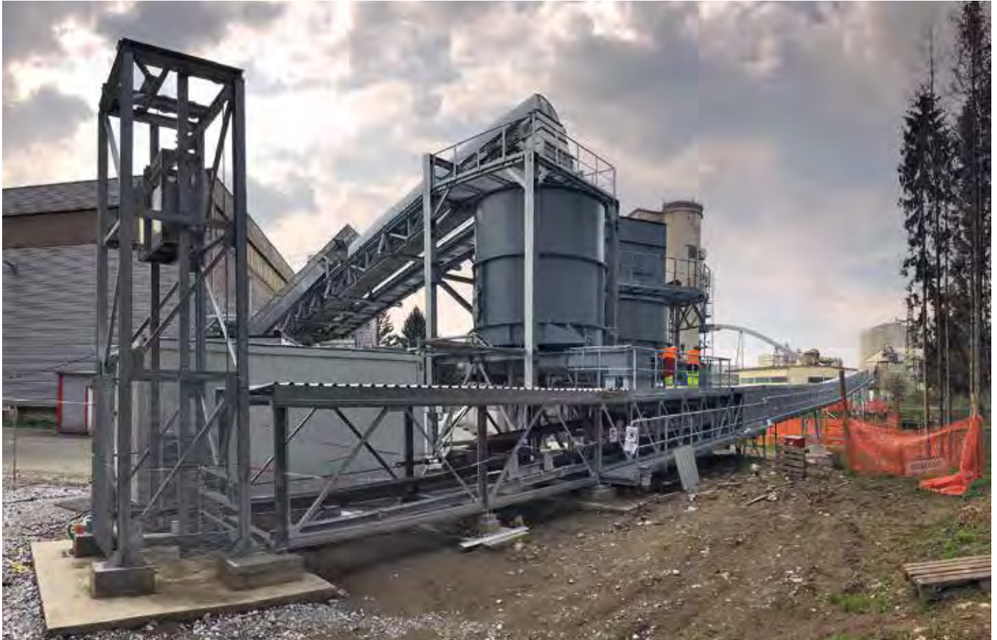
Bild 1: Zum Einsatz kommt das hochpräzise System bei der energieintensiven Herstellung von Zement (Bildnachweis: BEUMER Group GmbH & Co. KG)
