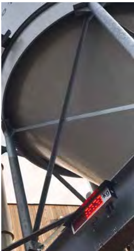
LED-Großanzeige zur besseren Ablesbarkeit des aktuellen Silofüllstandes
