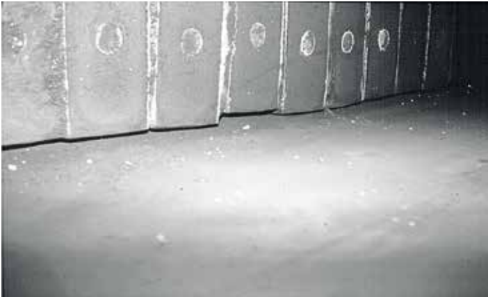
Bild 1: Mangelhaft ausgerichtete Verschleißauskleidungen bieten Ansatzpunkte für unerwünschten Materialeinschluss
