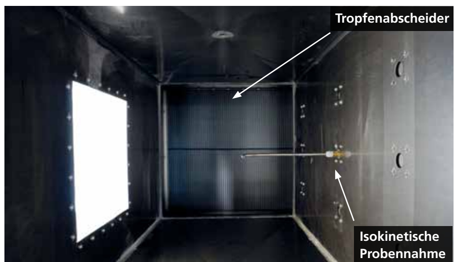
Bild 4 (oben): Foto aus dem Querschnitt der Messung mit Blick auf den nachgeschalteten Tropfenabscheider (Querschnittsfläche: 0,97 \text{ m}^2 )
