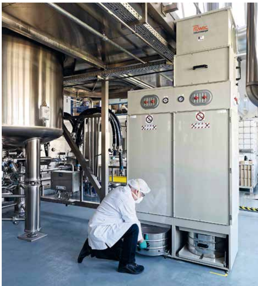
Der Reststaub wird gesammelt und kann einfach der Entsorgung zugeführt werden. Das Antriebsaggregat der Absauganlage wurde im Freien aufgestellt (Bild: Ruwac Industriesauger GmbH).
