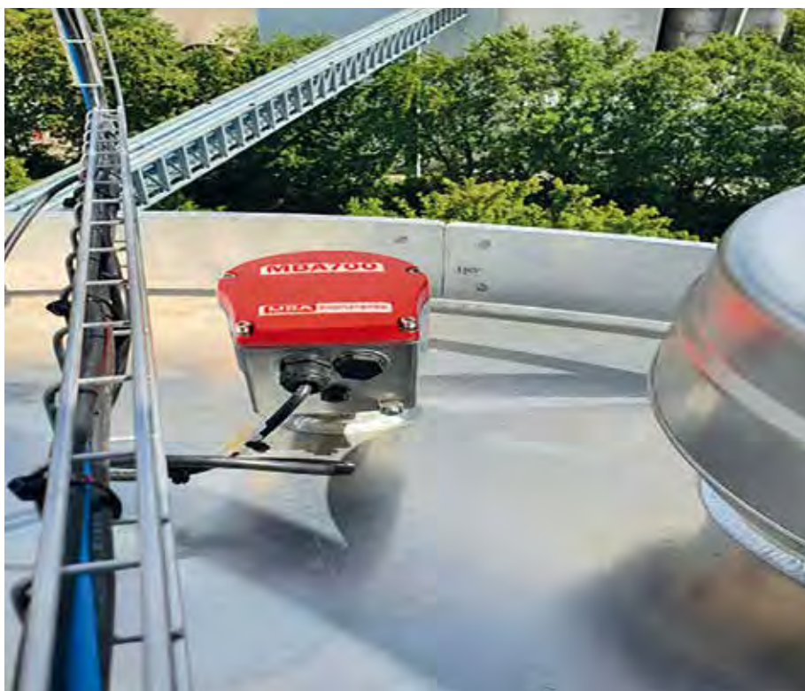
Einsatz des MBA700 auf den Silos der Firma Cerealien Bischheim GmbH
