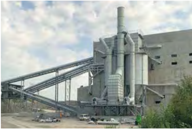
Blick auf die fertigmontierten Filteranlagen mit Ventilatoren und der gemeinsamen Schalldämpfer- und Abluftanlage mit Staubsilos und der neuen Produktionsanlage im Hintergrund
