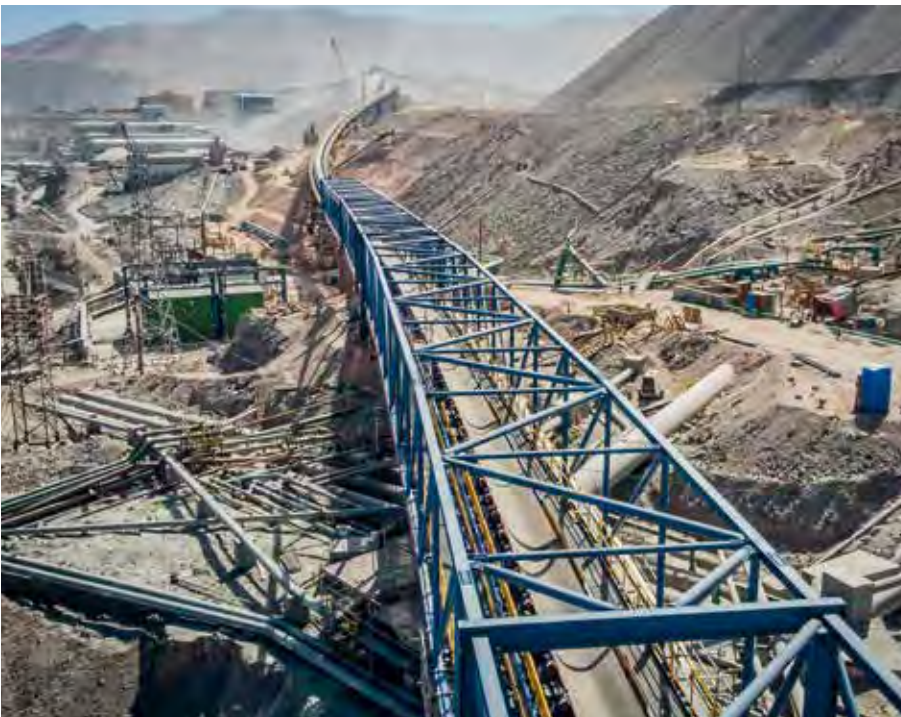
Overland Conveyor OLC-01 mit vorhandener Infrastruktur (Quelle: TAKRAF)
