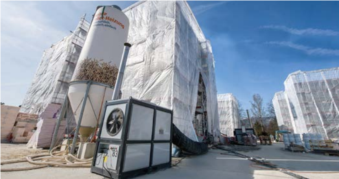
Mit den autarken IoT-Füllstandsensoren VEGAPULS Air lassen sich mobile Baustellenheizungen jederzeit exakt überwachen – für eine planbare, effiziente Versorgung und spürbare Einsparungen
