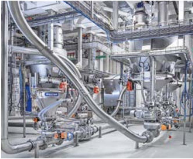
Pneumatische Fördersysteme aus Sendebehälter
