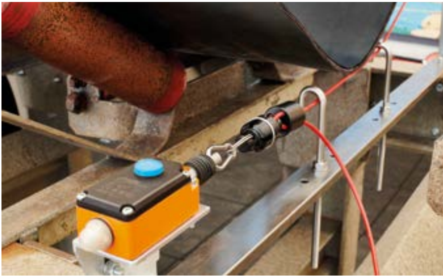
Das neue Bandrissüberwachungssystem erkennt frühzeitig einen Riss im Fördergurt und minimiert damit Folgeschäden
