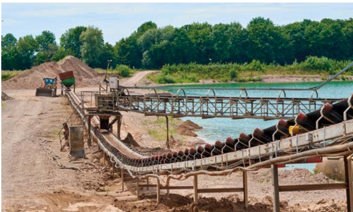
Schaltgeräte übernehmen verschiedene Sicherheits- und Überwachungsaufgaben an Gurtförderanlagen
