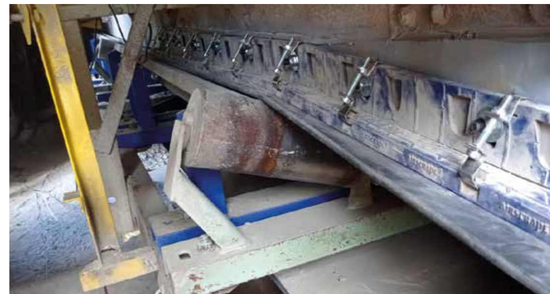
Ausstattung einer Übergabe mit dem AirScrape in einem Zementwerk in Spanien
