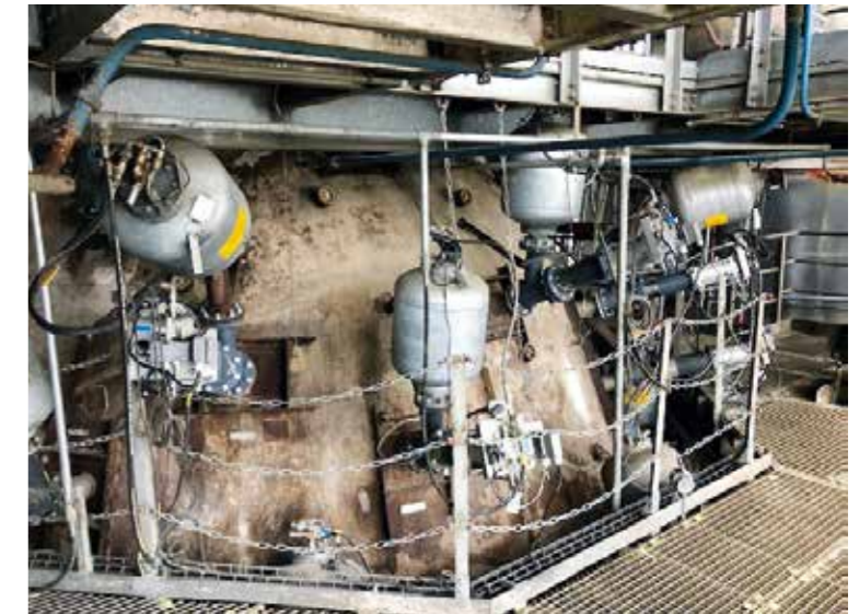
Ausfahrbare Heißbranddüsen im Einsatz
