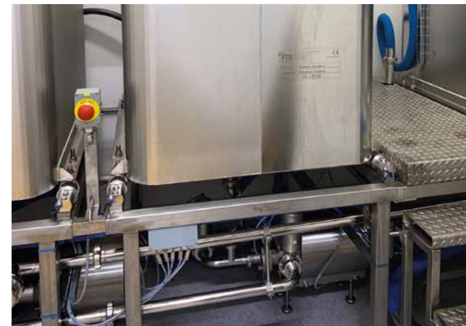
Die Tanks sind auf Eilersen Wägezellen des Typs BL montiert
