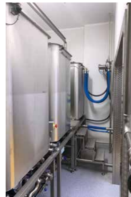
Die neue Anlage musste in die bestehenden Räumlichkeiten integriert werden
