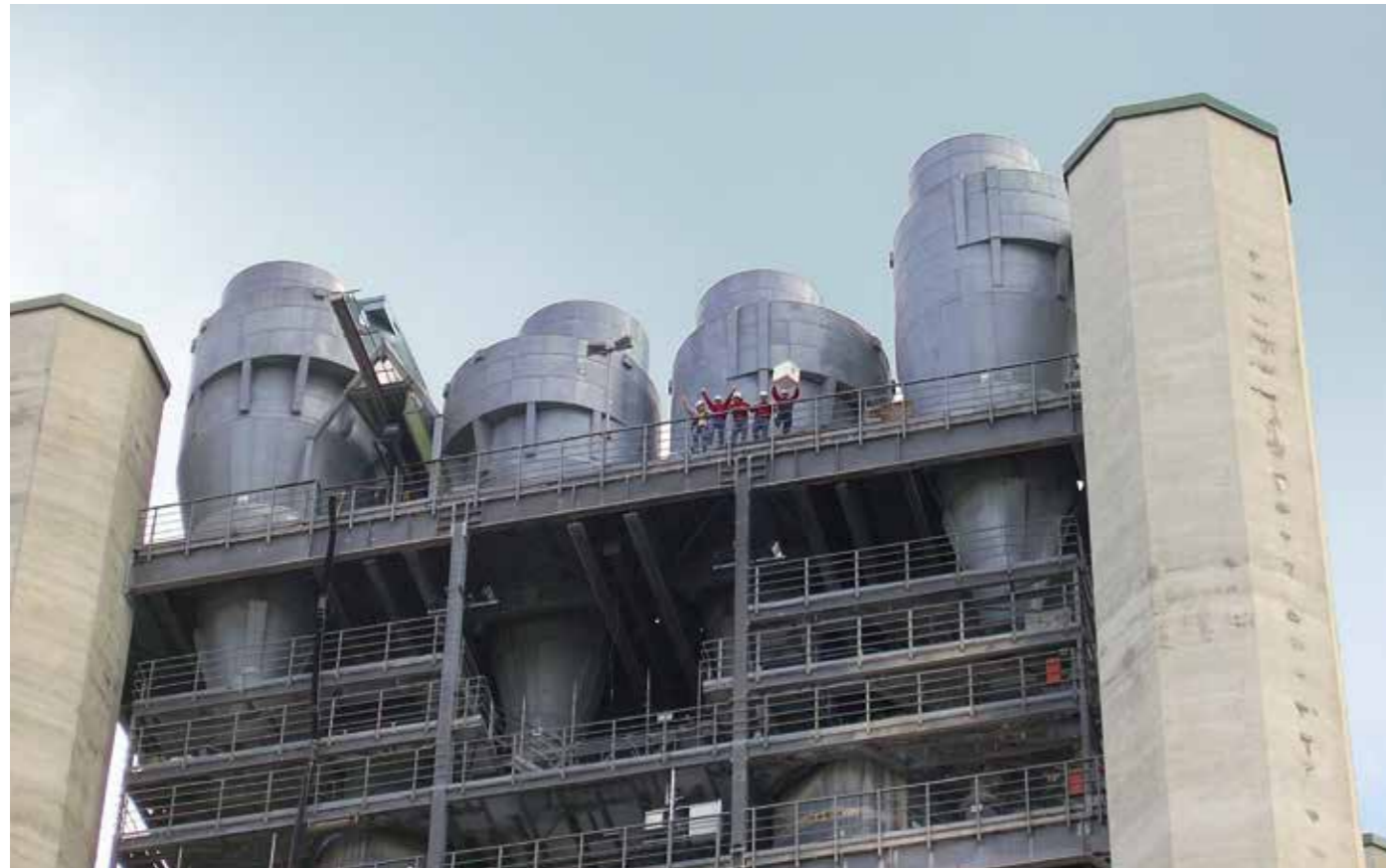
Projekt in Deutschland: verschleißfeste Auskleidung von Zyklonen mit SC-WearStop®
