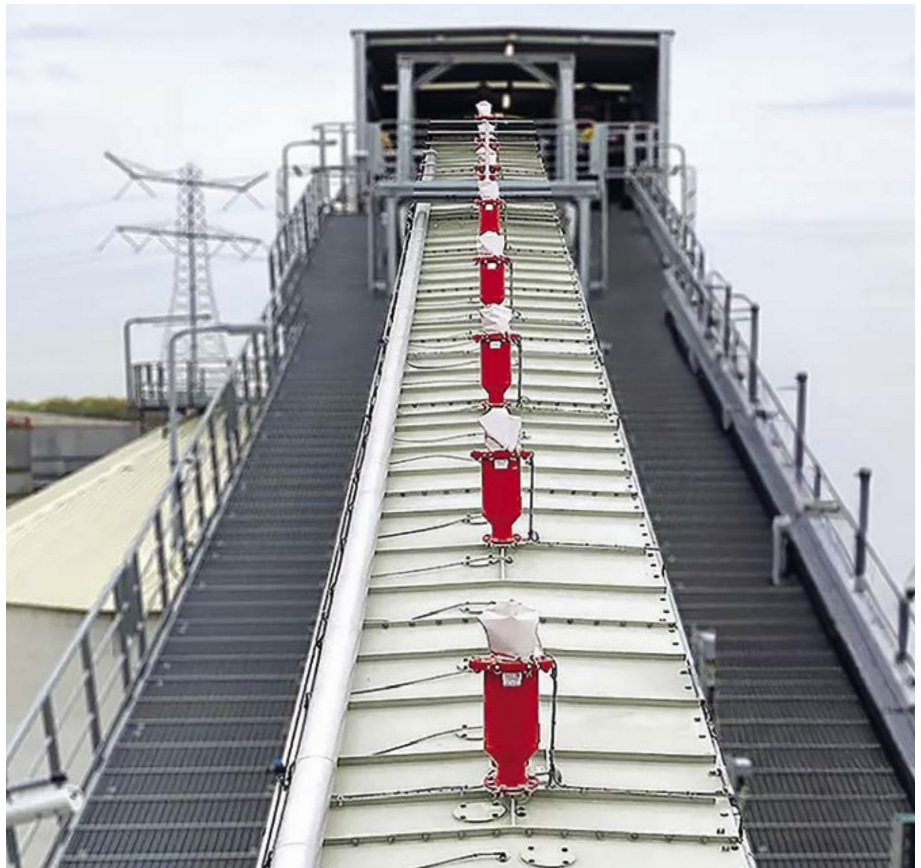
Anlage zur Explosionsunterdrückung in der Zuckerproduktion
