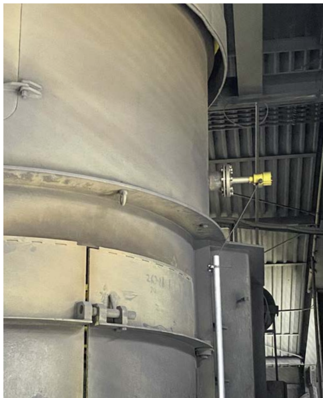
Die Bedingungen rund um den Schachtofen sind rau, die Sensoren von VEGA lassen sich jedoch weder von Staub noch von den hohen Temperaturen beeindrucken
