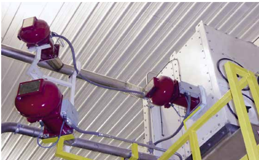
Die beiden Entkopplungssysteme links im Bild verhindern, dass eine Flammenfront sich im Rohrsystem ausbreitet. Das dritte, baugleiche Teil rechts erstickt – als Unterdrückungssystem verbaut – eine mögliche Explosion im Prozessbehälter bereits in der Entstehung.
