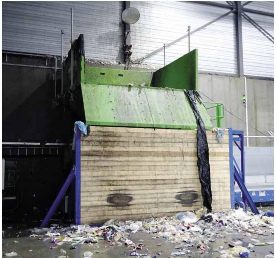
Objektschutzanlage über einem Schredder
