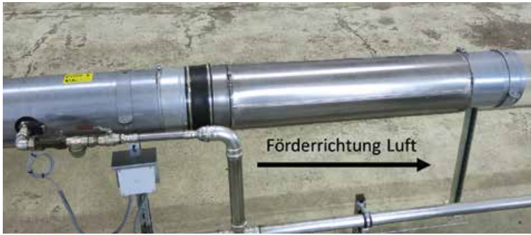
Bild 5: Abgebildet ist eine pneumatische Transportleitung von 250 mm Durchmesser, in der eine Luftgeschwindigkeit von 36 m/s von links nach rechts herrscht. Die Löschdüse befand sich 3 m links vom abgebildeten Plexiglasrohr (Bilder 1 bis 6: T&B electronic GmbH).
