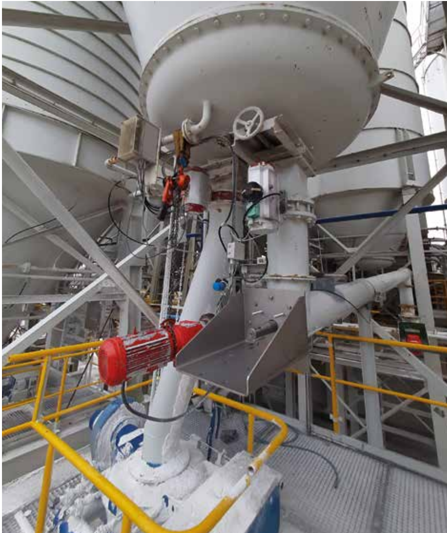
Das Bunkersilo mit einer Van Beek-Förderschnecke darunter, deren roter Getriebemotor noch in den Hebezeugen hängt (siehe Achszapfen und Stehbolzen zur Montage des Flanschlagers).
