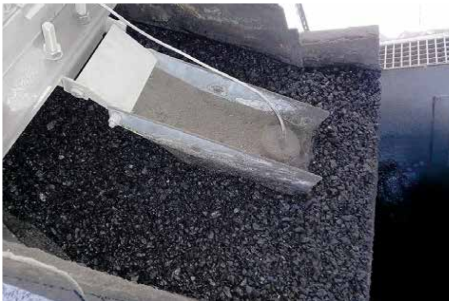
Sensor mit Gleitschuhschlitten auf Förderband für Kohle
