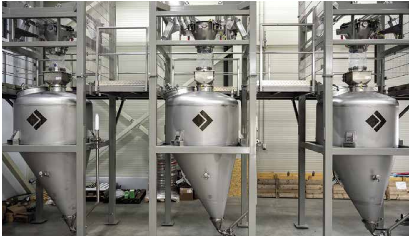
Die Big Bag-Entleerung in einer automatisierten Kombistation
