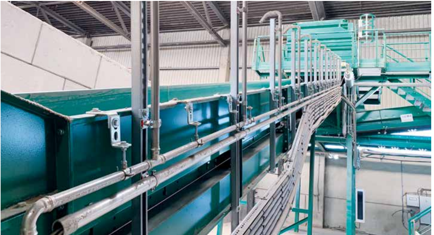
Steigförderband, geschützt durch flächendeckende Löschung von T&B. Für barrierefreie Wartungsarbeiten sind die Löschdüsen seitlich am Band montiert
