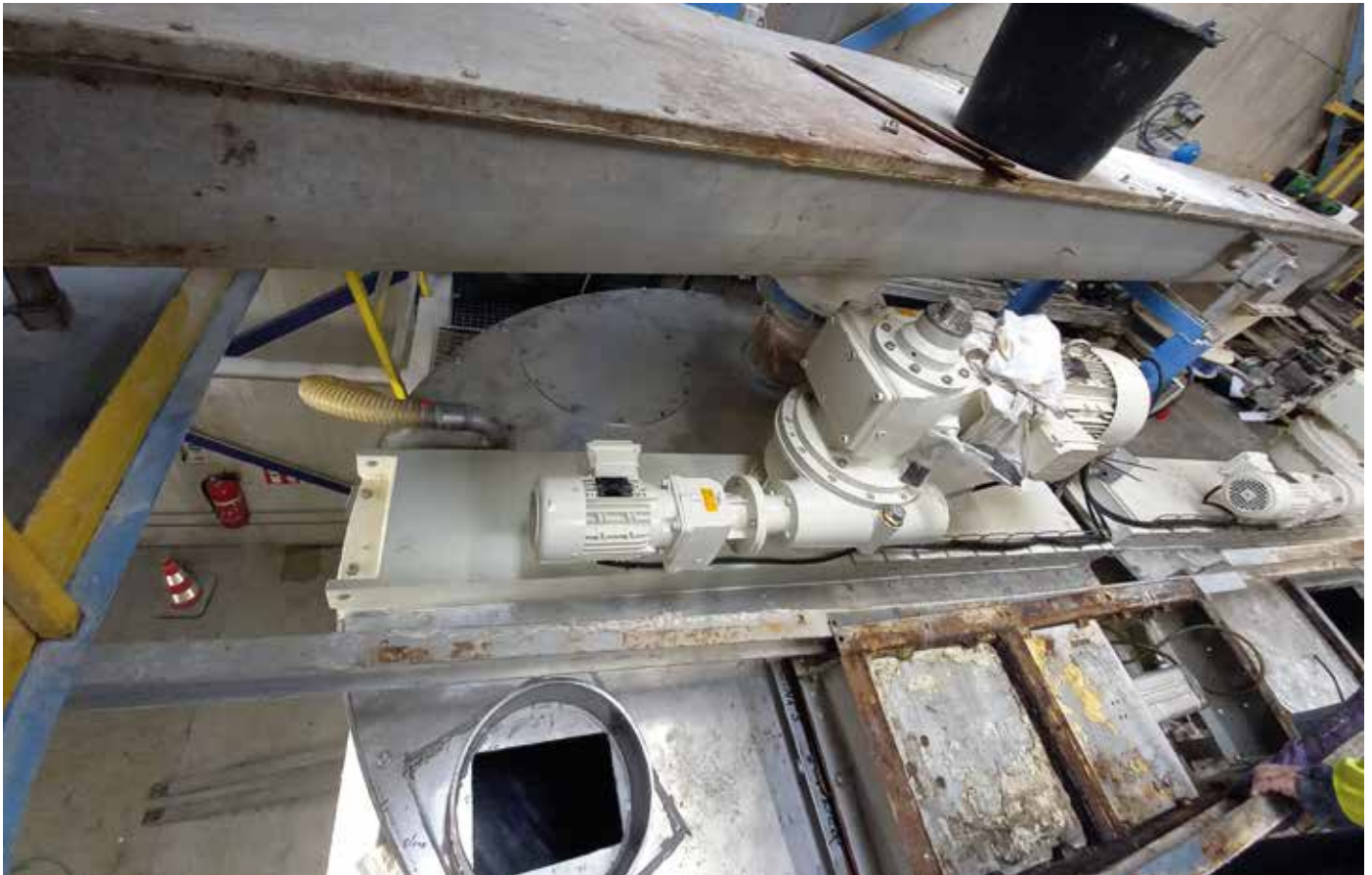
Im Bild zwei Nauta-Mischer, bei denen der Antrieb komplett modifiziert wurde.
