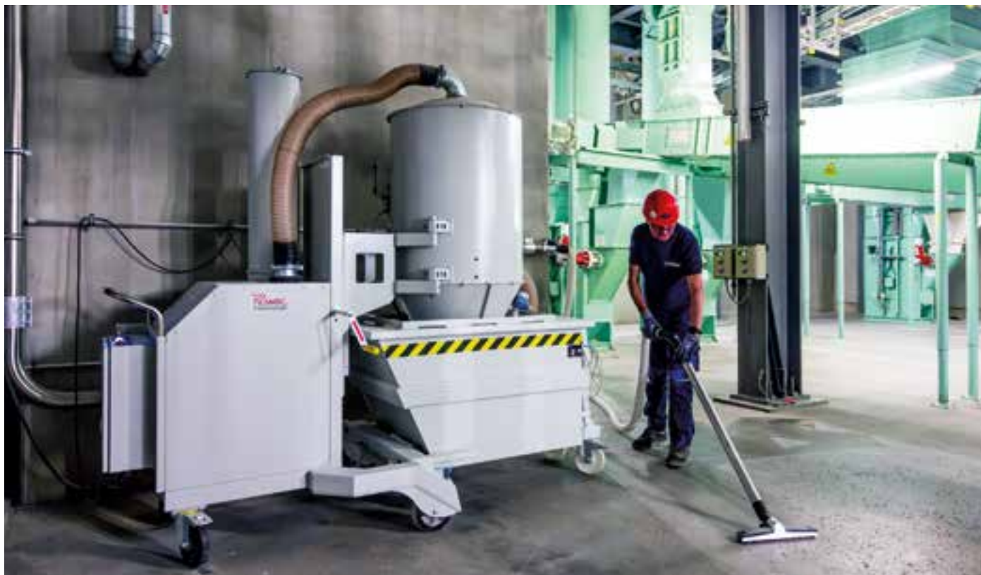
Die zentrale Absauganlage bei CropEnergies erlaubt Reinigungsarbeiten auf fünf Ebenen
