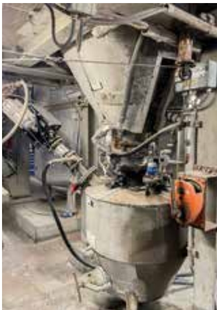
Das Fördersystem der Altanlage
