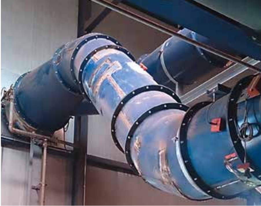
Hier zeigt sich eine aufwändige Instandhaltung am Rohrsystem
