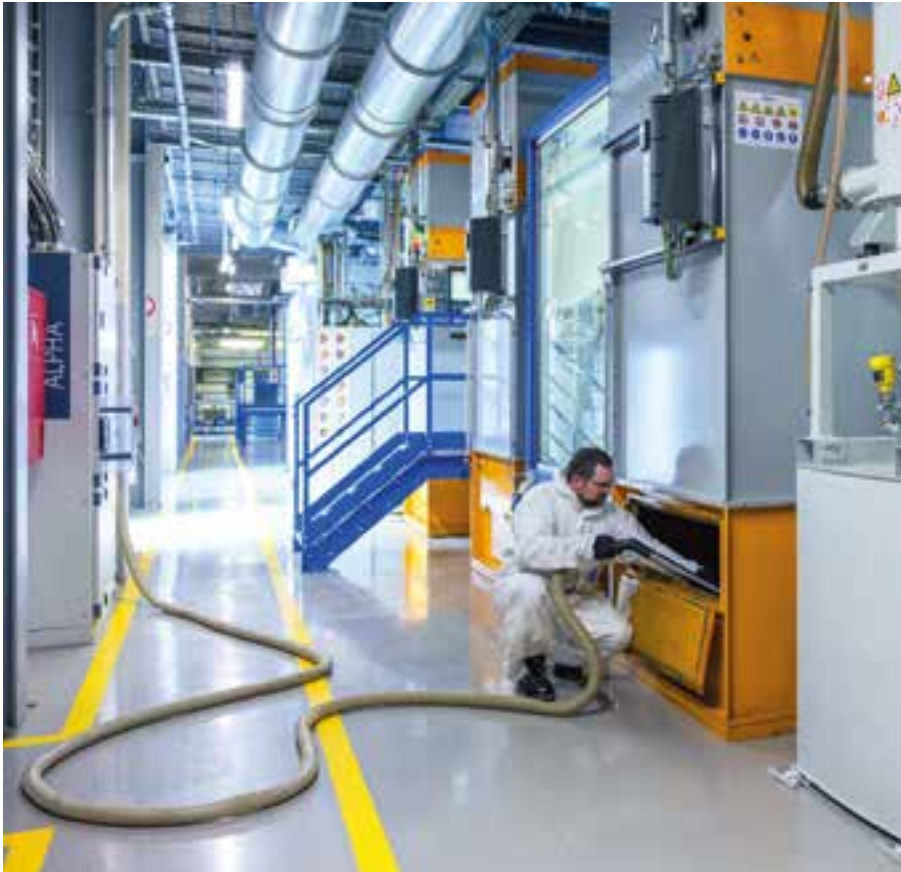
So lassen sich die Filterkästen der manuellen Pulverkabinen bei Bomag komfortabel entleeren. Im Vordergrund: Die Filtereinheit der Absauganlage (oben), und darunter die Vakuumzelle
