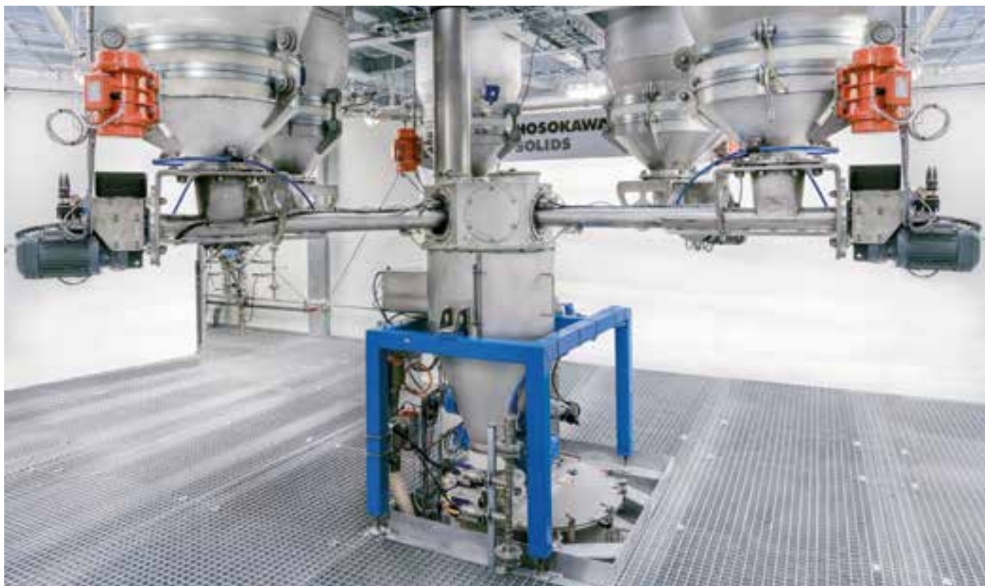
Drehschalenwaage mit Dosierbehältern und Vibrationsdosierschnecken
