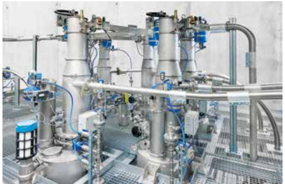
Taktsaugfördergeräte auf Dosierbehältern
