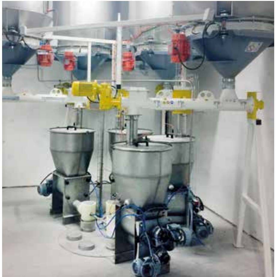
Die Vibrationsaustragsböden mit den Aktivatoren verhindern Anhaftungen sowie den Staubaustritt – hier in der Mühle VELIA im französischen Beaufreau
