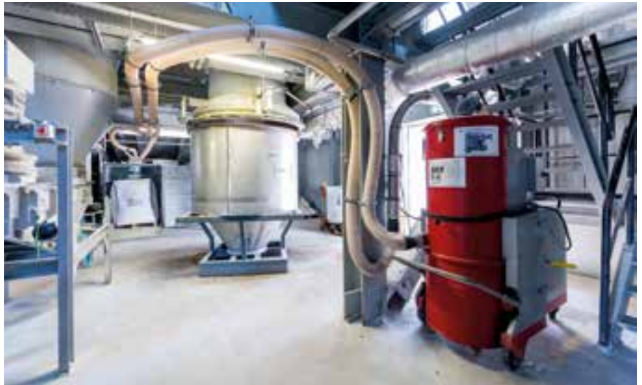
Die zentrale Sauganlage bei Knauf Insulations (rechts) ermöglicht die Betriebsreinigung in der gesamten „Gemengehalle“ – auf mehreren Ebenen. Links im Hintergrund: die Vakuumszelle
