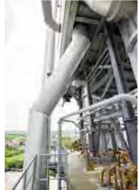
Die Dimension der Rohrleitungen lässt erahnen, wie hoch der Bedarf an Prozessluft in GGR-Öfen ist
