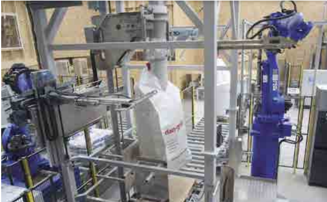
Vollautomatische Befüllung von 1-Schlaufen-Big-Bags von Rolle
