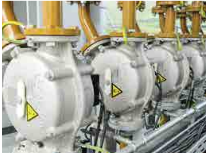
Der Braunkohlestaub wird von Delta Blowern von AERZEN durch Brennerlanzen hindurch in den Brennofen geblasen
