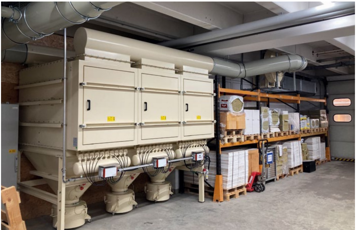
Taschenfilteranlage INFA-JET AJN für die zentrale und effiziente Entsorgung von 11 Absaugstellen
