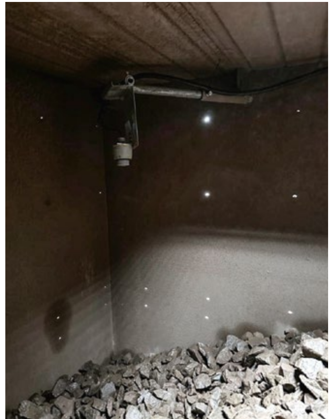
Sicher trotz Staub und Verschmutzungen: Kompakte VEGAPULS-Sensoren arbeiten wartungsfrei und liefern im Puffersilo rund um die Uhr präzise Messergebnisse
