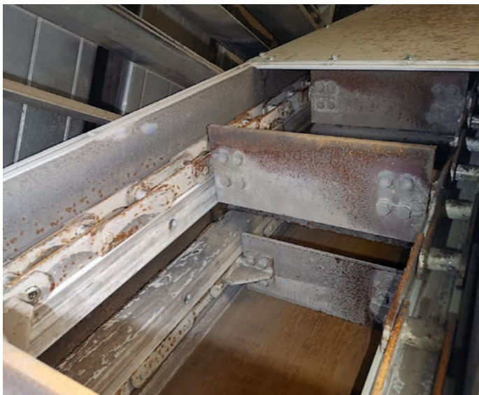
Harte Einsatzbedingungen im Aschekratzer: An den neuralgischen Stellen wurden wendbare Ketten- gleitleisten aus Kunststoff verbaut (© FB Ketten)
