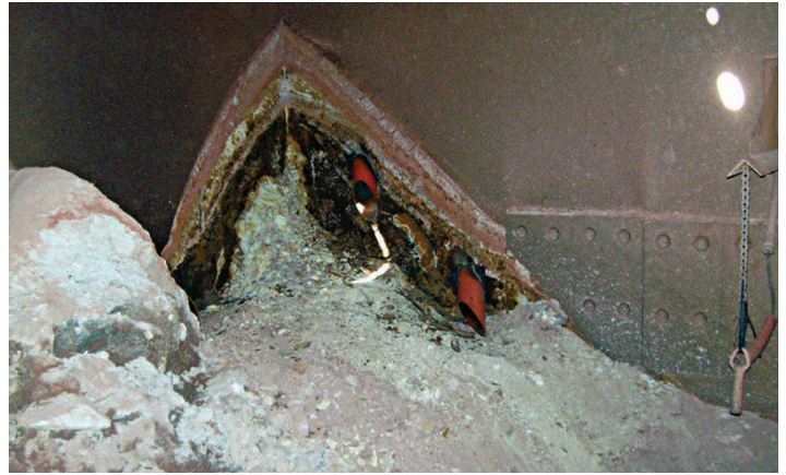
Bild 13: Die Ausblasdüsen für ein Luftkanonensystem sind in der Schurrenwand eingebettet, damit sie unter der Schicht des angesammelten Materials entladen können und auch darüber hinaus den Materialfluss möglichst wenig beeinträchtigen
