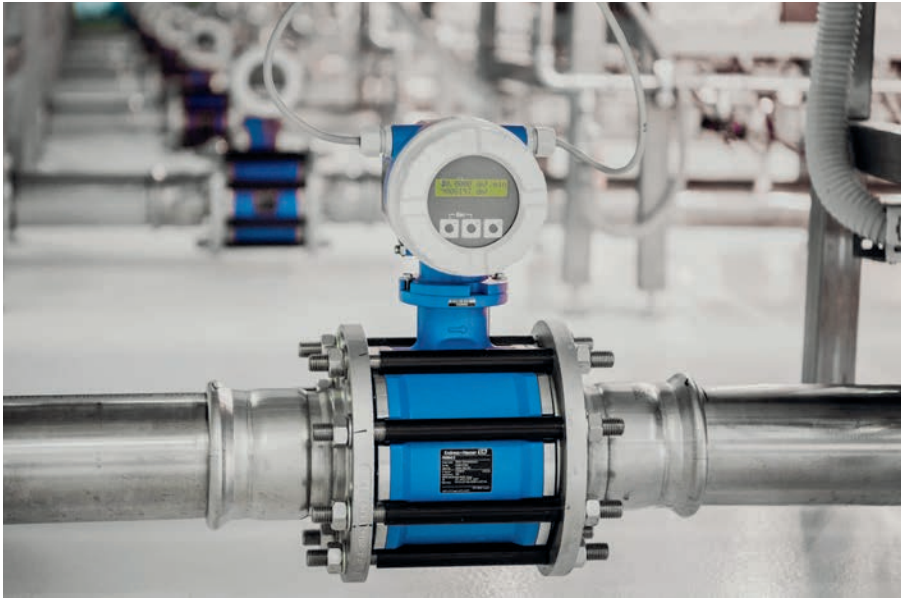
Die Fließgeschwindigkeit wird mit dem magnetisch-induktiven Durchflusssensor Promag 10D erfasst.
