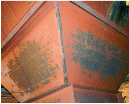
Bild 3: Das Einschlagen auf die Bunker- oder Schurrenwand mit einem Hammer führt zu einer Beschädigung der Wandungsoberfläche
