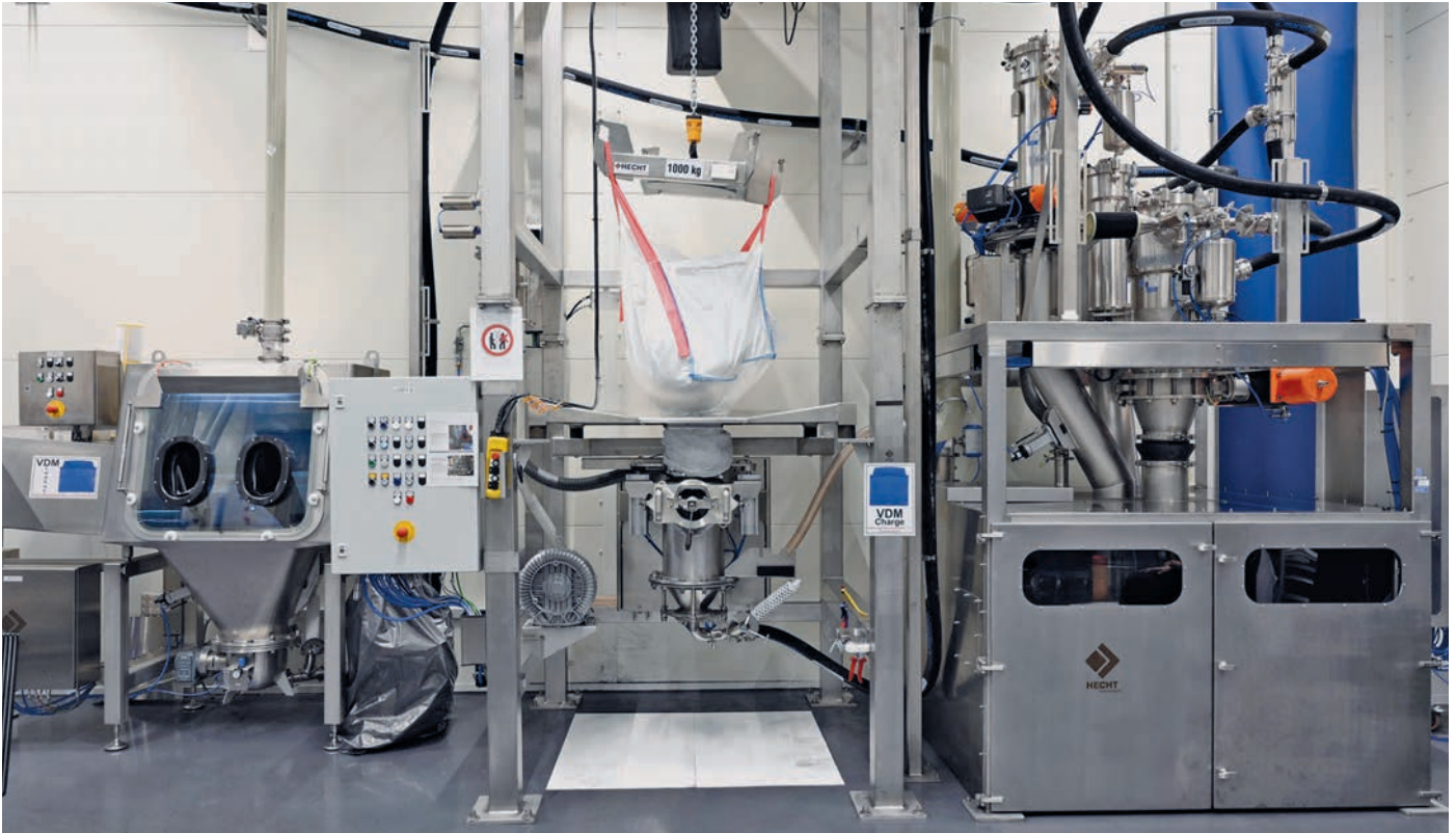
Aufgabestation mit Big Bag-Entleerung und Förderung
