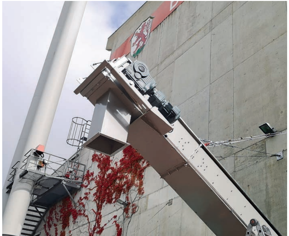
Deutliche Lärmreduktion: FB Ketten fand eine maßgeschneiderte Lösung für den Aschetrogkettenförderer beim Biomasse-Heizkraftwerk Kaufering (© FB Ketten)
