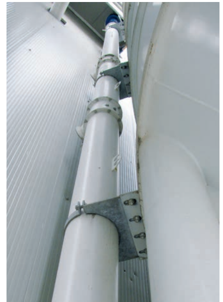
Vertikale Förderschnecke in einem Zementwerk
