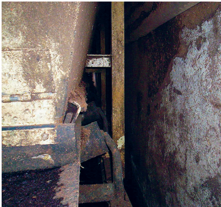
Der geringe Abstand zur Tunnelwand erschwert Wartung und Instandhaltung dieser Förderanlage erheblich.
