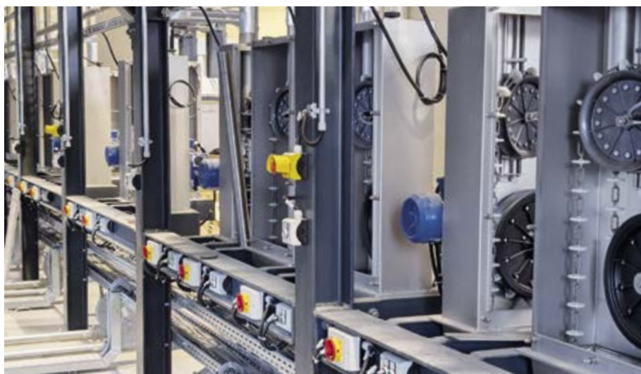
In den Rohren werden die Kunststoff-Flakes von A nach B transportiert. Mit der Entscheidung für die Rohrkettenförderer ist man bei Vogt Plastic sehr zufrieden.
