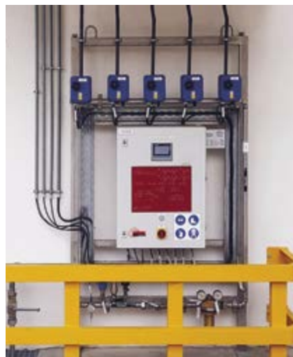
Bild 3: Gasanalysensysteme erkennen rechtzeitig Gefahrensituationen
