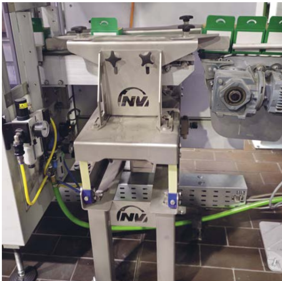
Vibrationstisch direkt im Übergabebereich der Verpackungslinie
