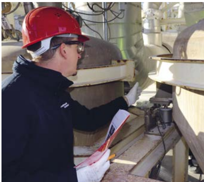
Serviceeinsatz vor Ort: Anwendungsspezialist Stefan Christians prüft die Ein- und Auslaufrohre auf mögliche Kraftnebenschlüsse
