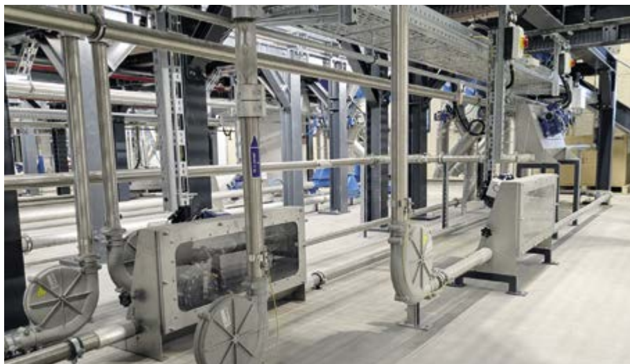
In den Rohren werden die Kunststoff-Flakes von A nach B transportiert
