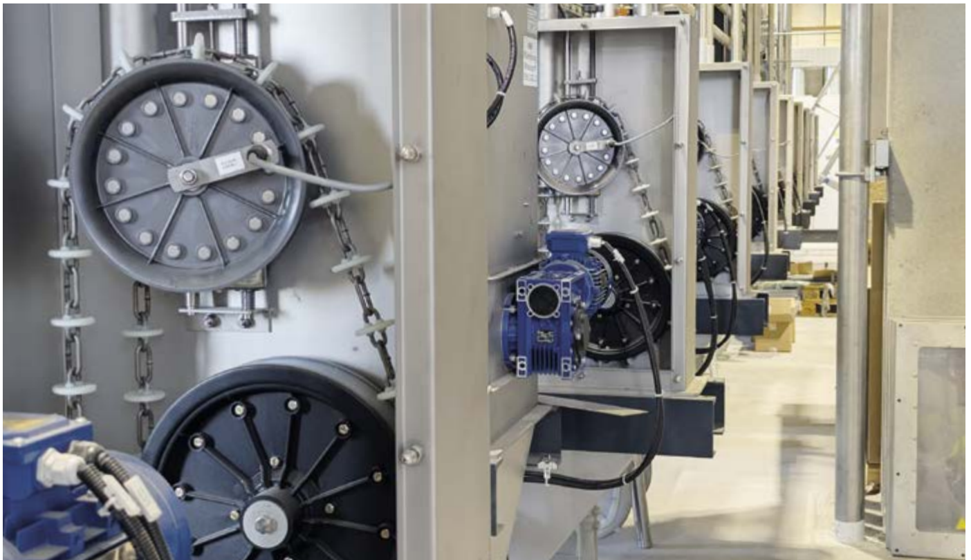
Vogt Plastic setzt im Kunststoffrecycling auf Rohrkettenförderer (Fotos: Wessjohann fördertechnische Anlagen GmbH)
