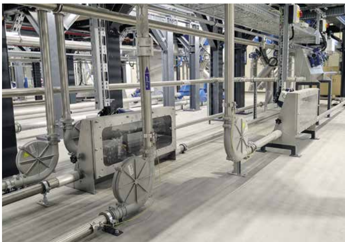
In den Rohren werden die Kunststoff-Flakes von A nach B transportiert
