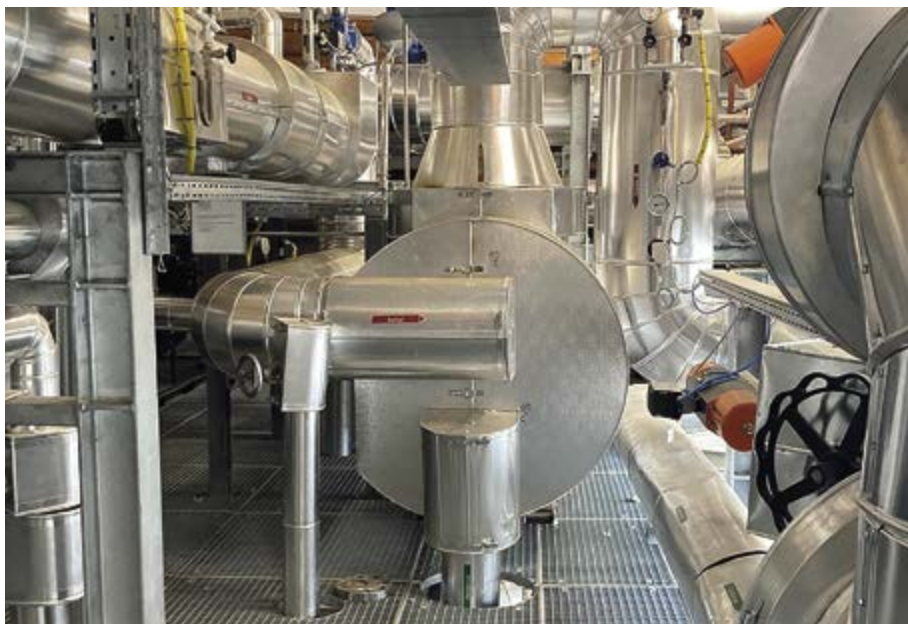
Kopfansicht des Wärmetauschers nach der Modernisierung
