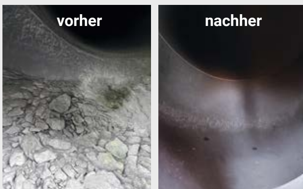
Abb. 2: Massive Ablagerungen in der Strömungsumlenkung eines Abluftkanals [links]; selber Abluftkanal unter dem regelmäßigen Einsatz einer Luftkanone [rechts], © VSR
